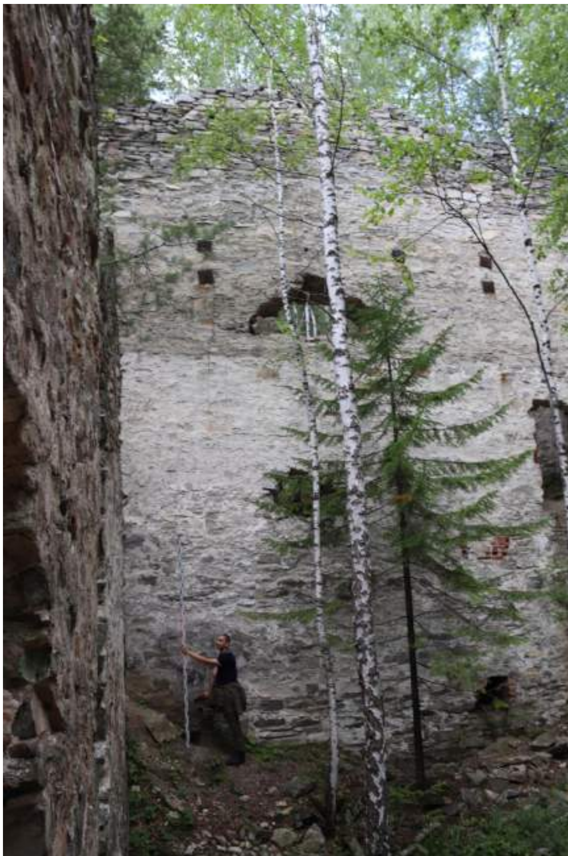
Графическое приложение №16 . ОКН «Французская горка. Французский замок – развалины (руины) бельгийской фабрики XIX века». Руинизированное здание фабрики. 1 Вид с востока.
