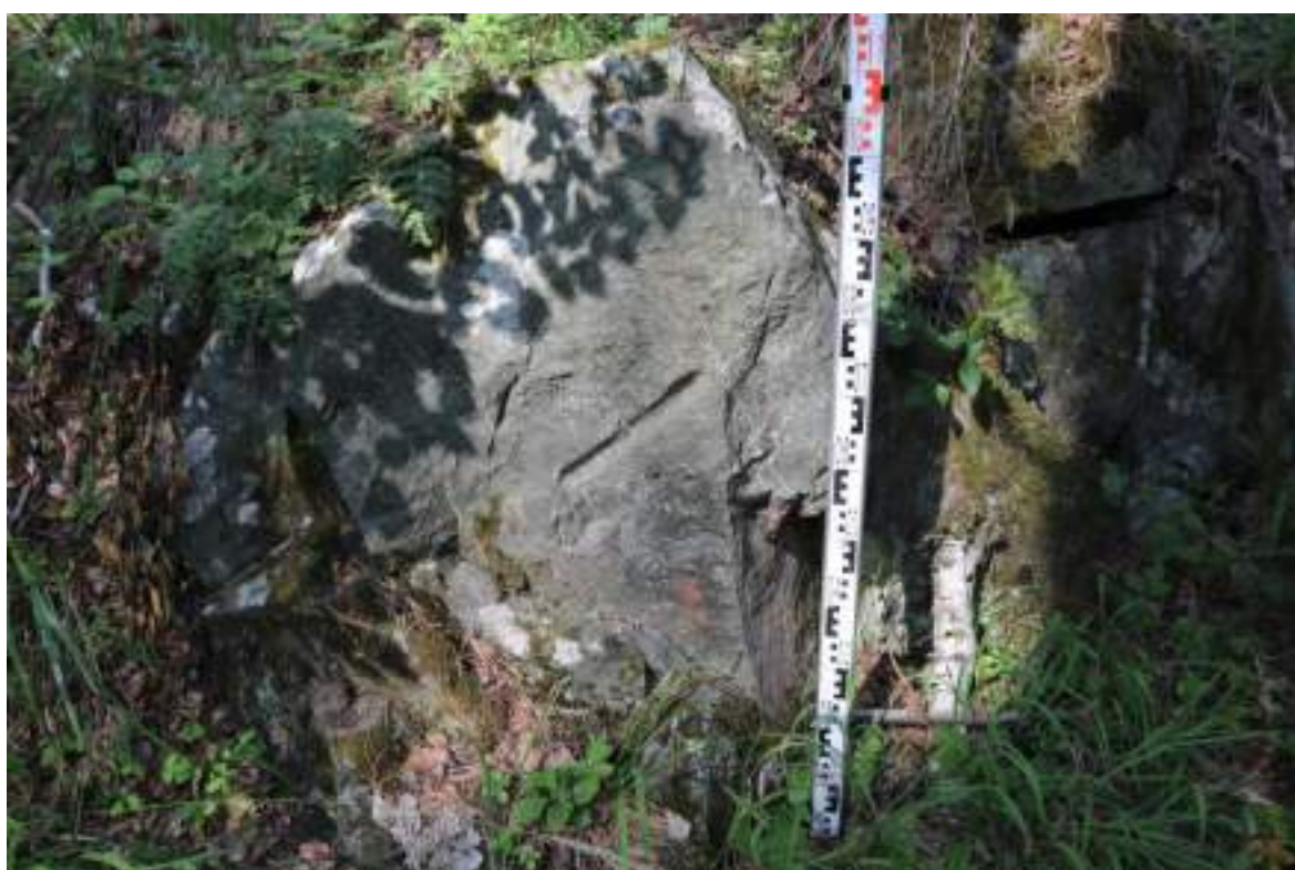
Графическое приложение №27 . ОКН «Французская горка. Французский замок – развалины (руины) бельгийской фактории XIX века». Бремсберг сд. Вид с востока.
