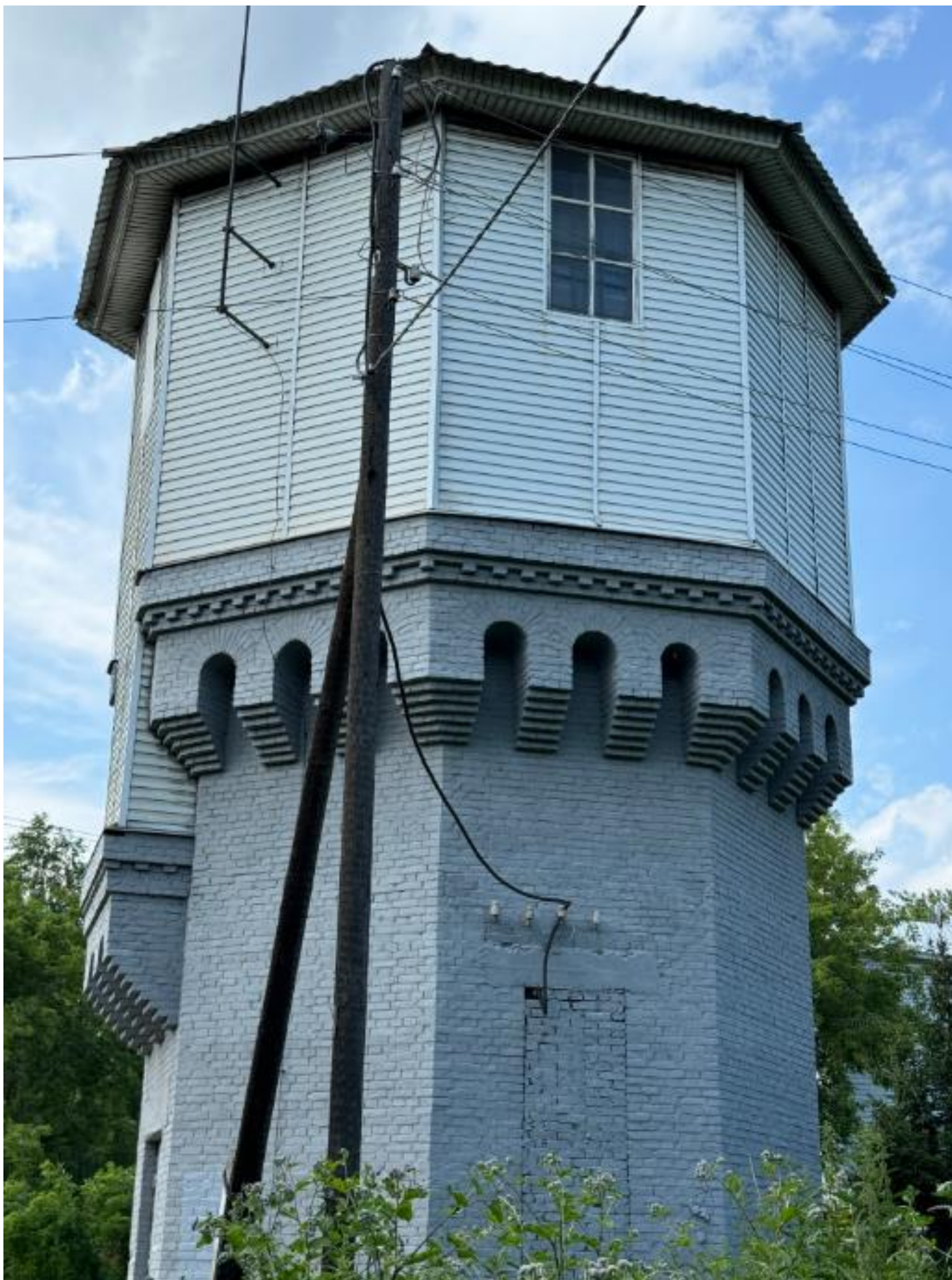
Фото 8. Вид на выявленный объект культурного наследия «Водонапорная башня-2», расположенный по адресу: Челябинская область, Миасский городской округ, г. Миасс, ж/д ст. Миасс-1.
