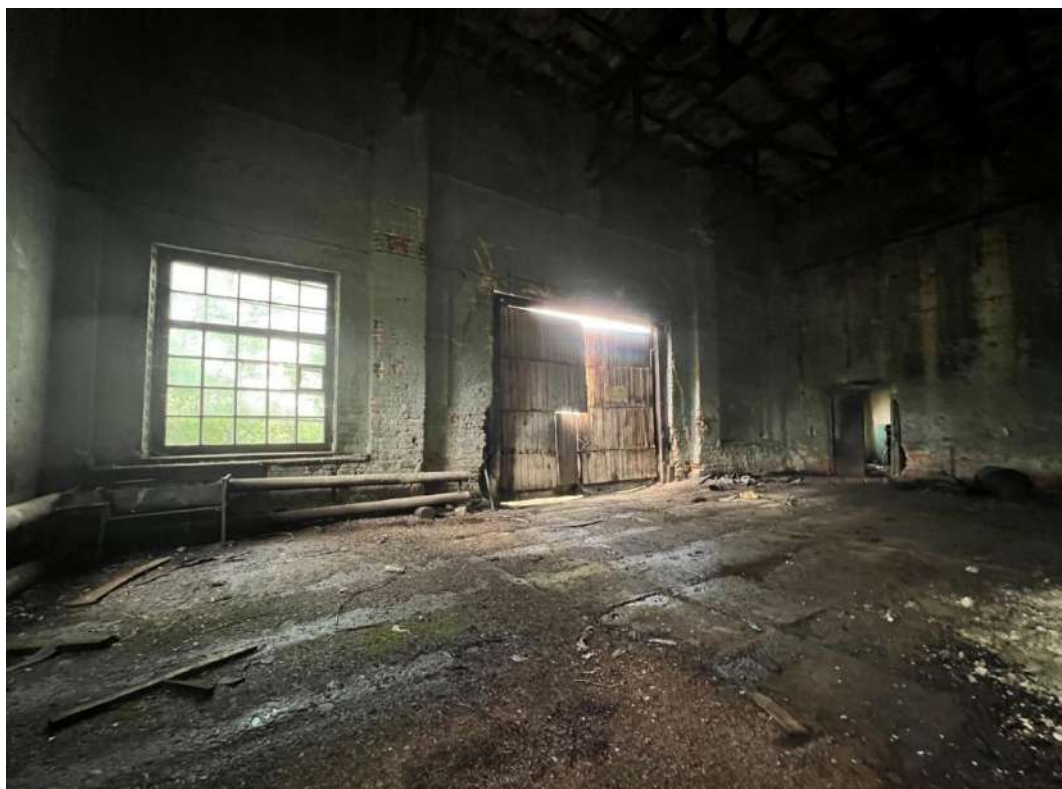
Рис. 18. Машинный зал электростанции. Западная стена. Ворота въезда, прорубленные на месте исторических оконных проемов
