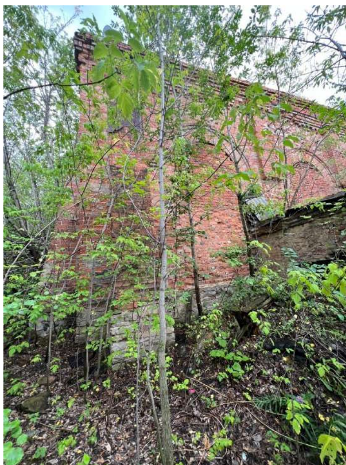
Рис. 4. Фрагмент бокового, северного фасада. Левый фланг. Заложенные оконные проемы и фланговый контрфорс
