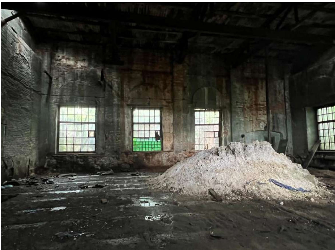
Рис. 14. Машинный зал электростанции. Восточная стена
