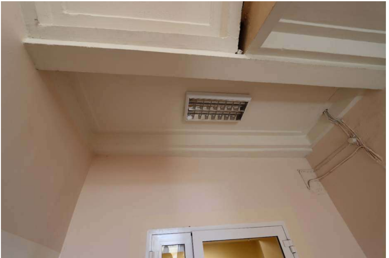
Рис. 53. 3 этаж, запасная лестница западного крыла, потолок лестничного пролета
