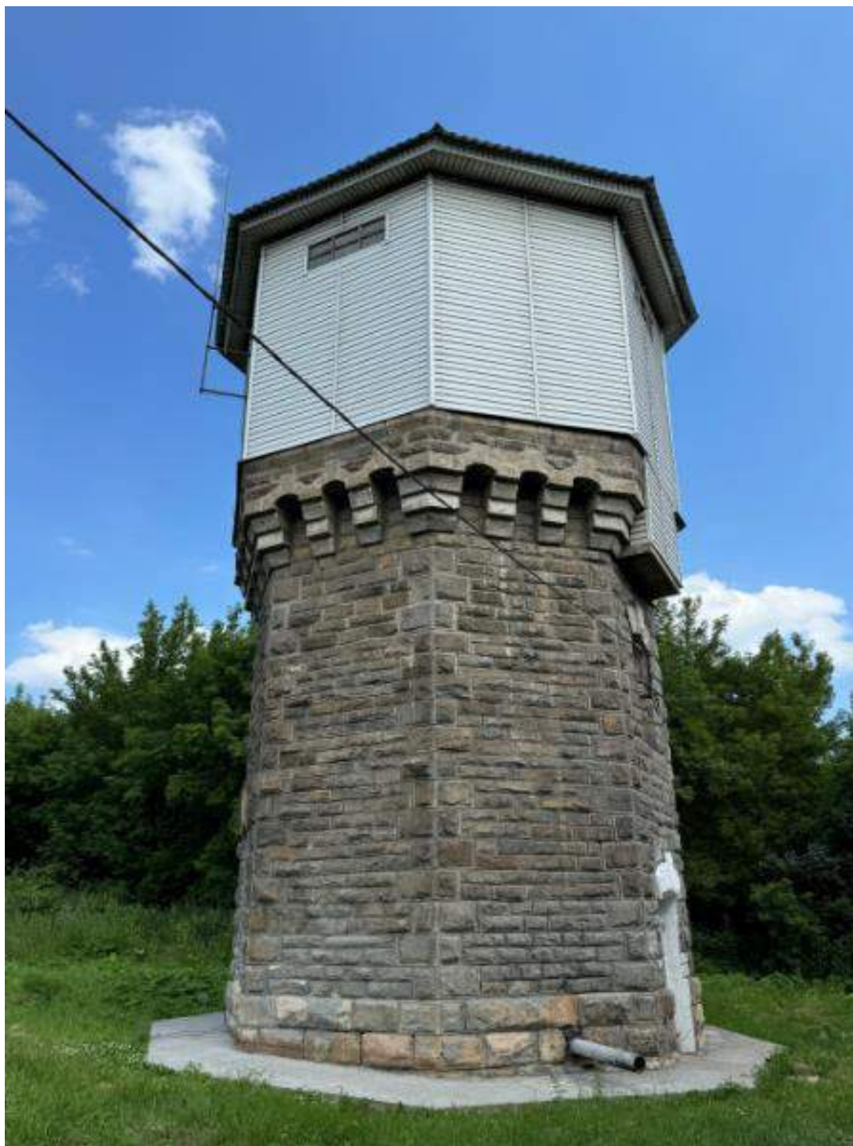
Фото 4. Вид на выявленный объект культурного наследия «Водонапорная башня-1», расположенный по адресу: Челябинская область, Миасский городской округ, г. Миасс, ж/д ст. Миасс-1.
