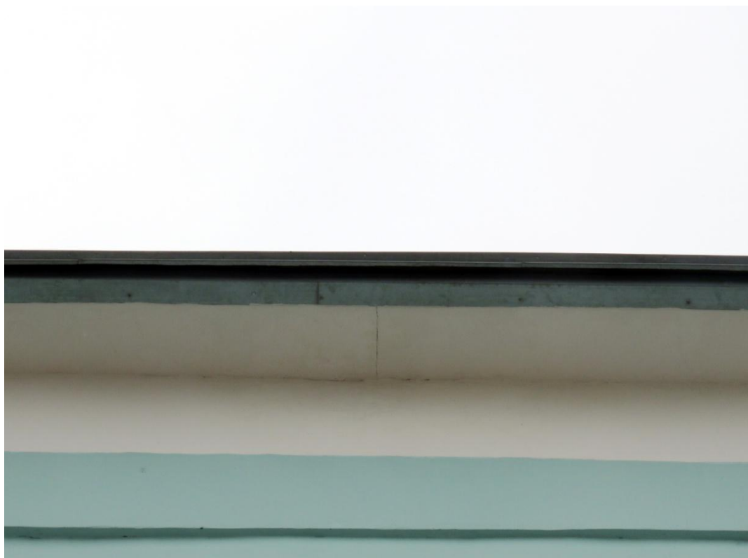
Рис. 15. Существующий венчающий карниз северной части здания (исторический карниз утрачен)
