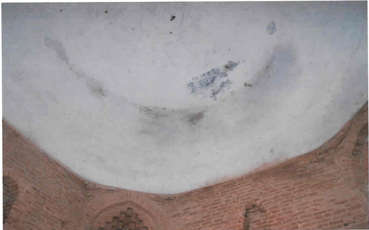
Фото 13. Фрагмент купольного свода основного объема сооружения. Локальные отслоения окрасочного слоя в зонах намокания
