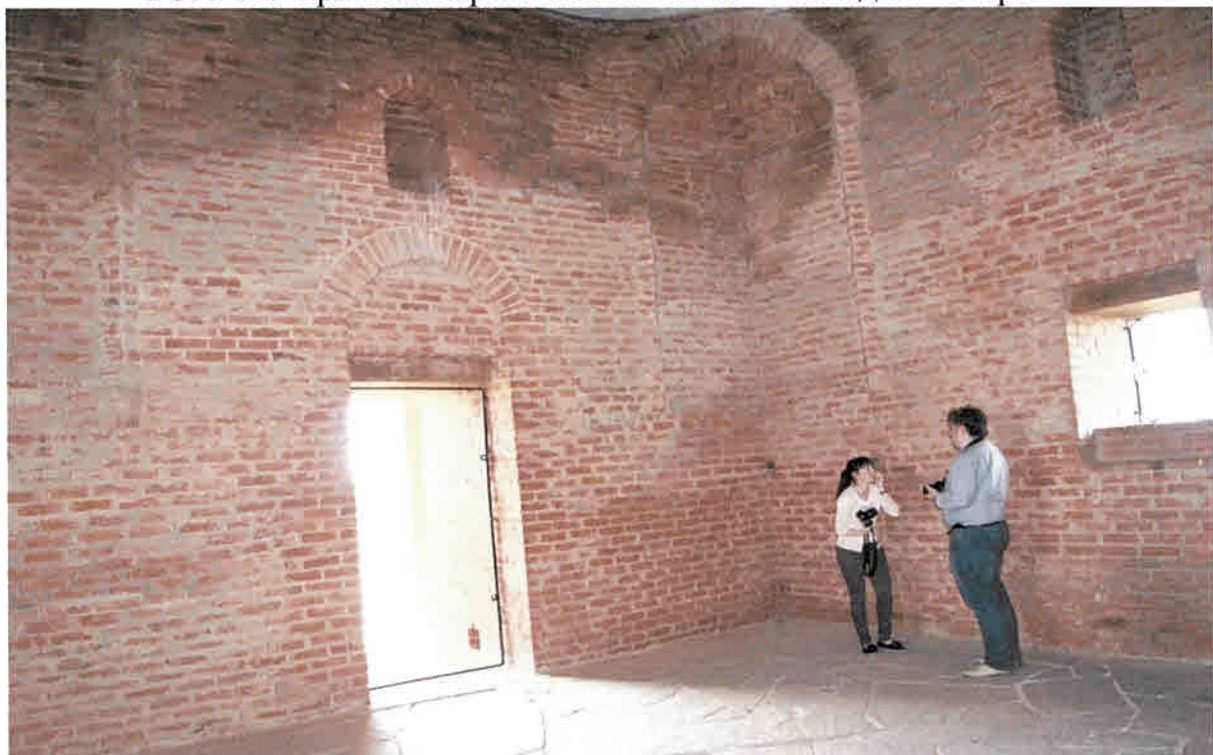
Фото 12. Фрагмент стены основного объема сооружения. Следы намочания кирпичной кладки южной стены и ниш.
