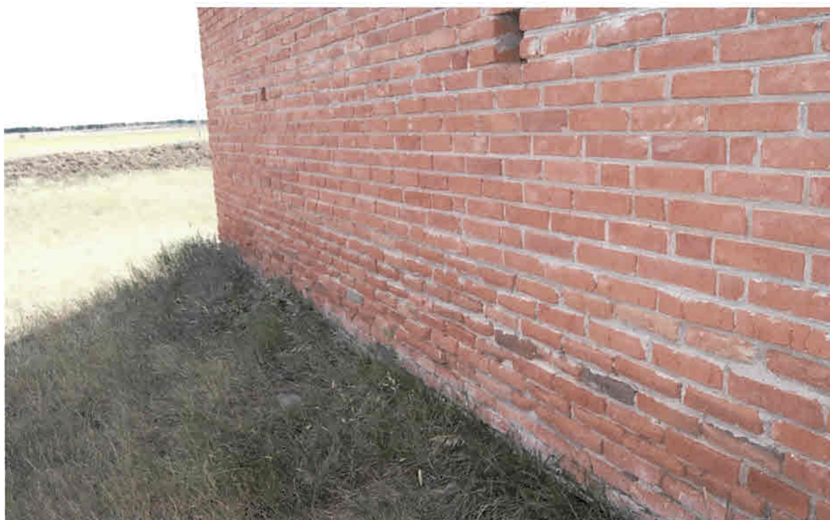
Фото 6. Фрагмент северного фасада сооружения. Поверхностное разрушение кирпичной кладки стены, выветривание кладочных швов в этих зонах
