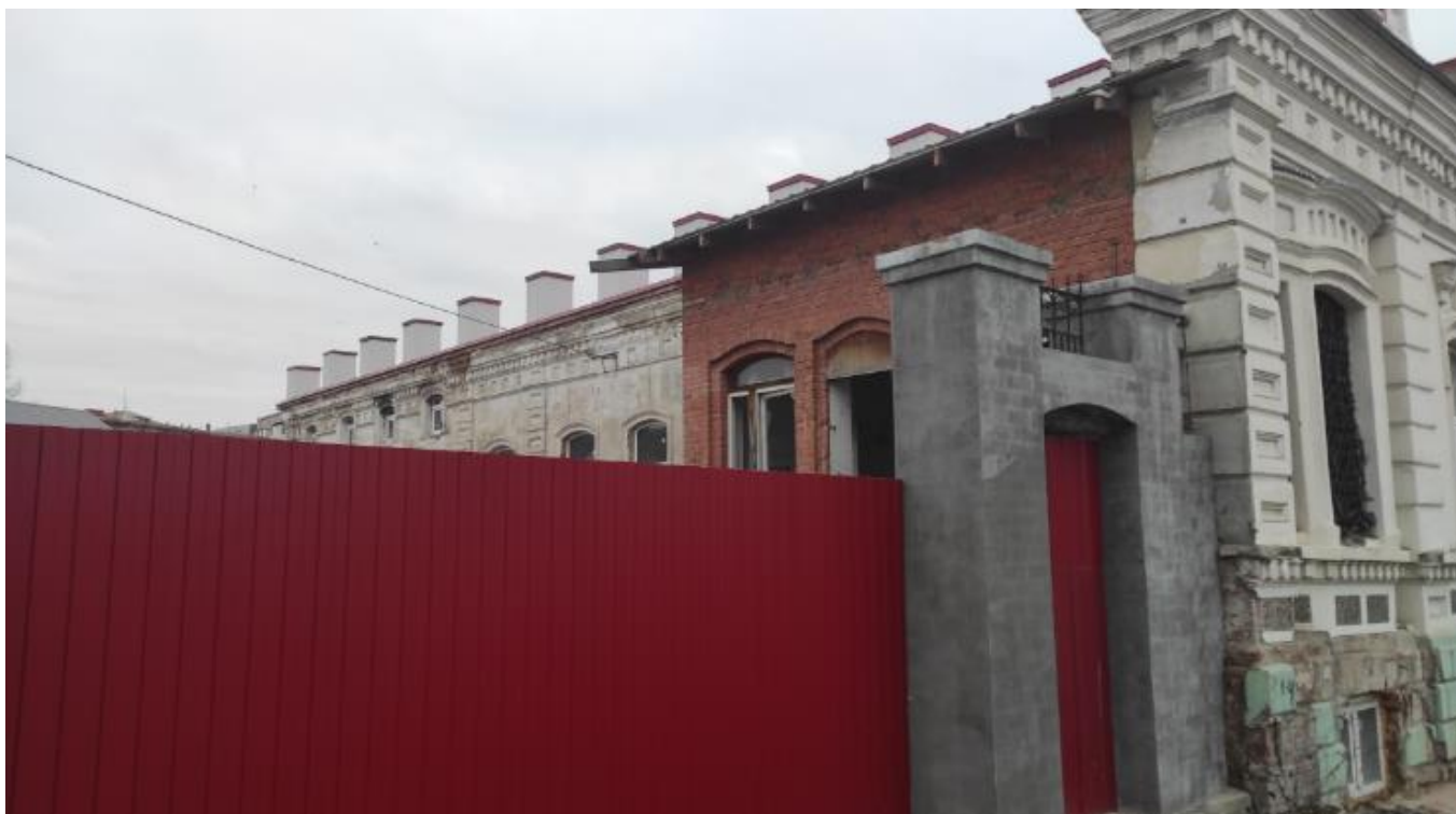
Фото 15. Вид на выявленный объект культурного наследия «Комплекс зданий Кузнецова-Бакакина», расположенный по адресу: Челябинская область, Миасский городской округ, г. Миасс, ул. Ленина, 12.
