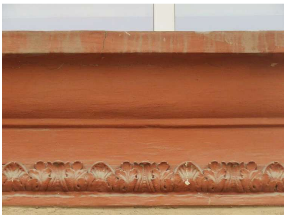
Рис. 6 а, б. Фрагмент колоннады портика главного фасада. Оконный проем портика и оформление межэтажного карниза
