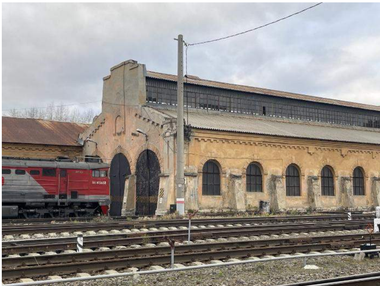
Фото 7. Выявленный объект культурного наследия «Здание паровозного депо» по адресу: Челябинская обл., г. Верхний Уфалей, 107 км. Восточный фасад выявленного объекта культурного наследия.
