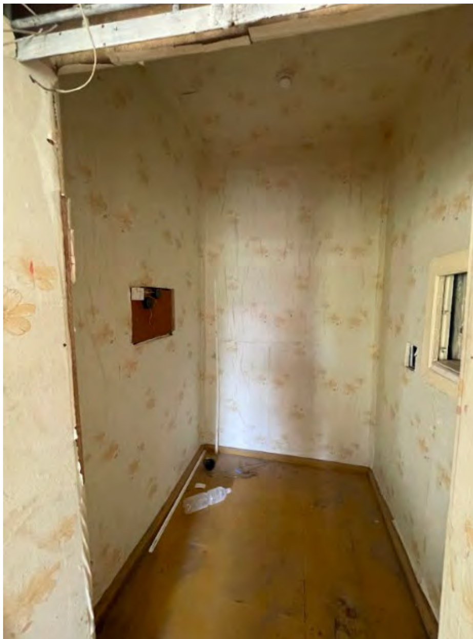
Фото 30. Выявленный объект культурного наследия «Дом купца А.Н. Якушева» по адресу: Челябинская обл., г. Верхний Уфалей, Каслинская ул., 1. Интерьер выявленного объекта культурного наследия. Помещение 3.
