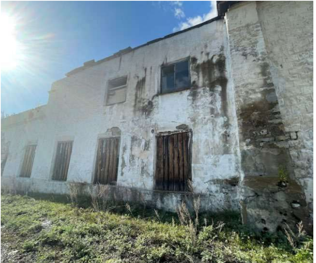
Фото 15. Выявленный объект культурного наследия «Здание железнодорожного депо» по адресу: Челябинская обл., г. Нязепетровск, Кутасова ул. Фрагмент восточного фасада южной части выявленного объекта культурного наследия.
