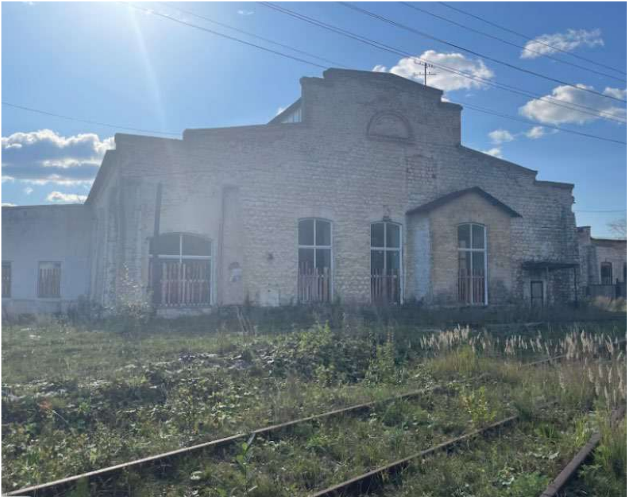
Фото 6. Выявленный объект культурного наследия «Здание железнодорожного депо» по адресу: Челябинская обл., г. Нязепетровск, Кутасова ул. Северный фасад восточной части выявленного объекта культурного наследия.
