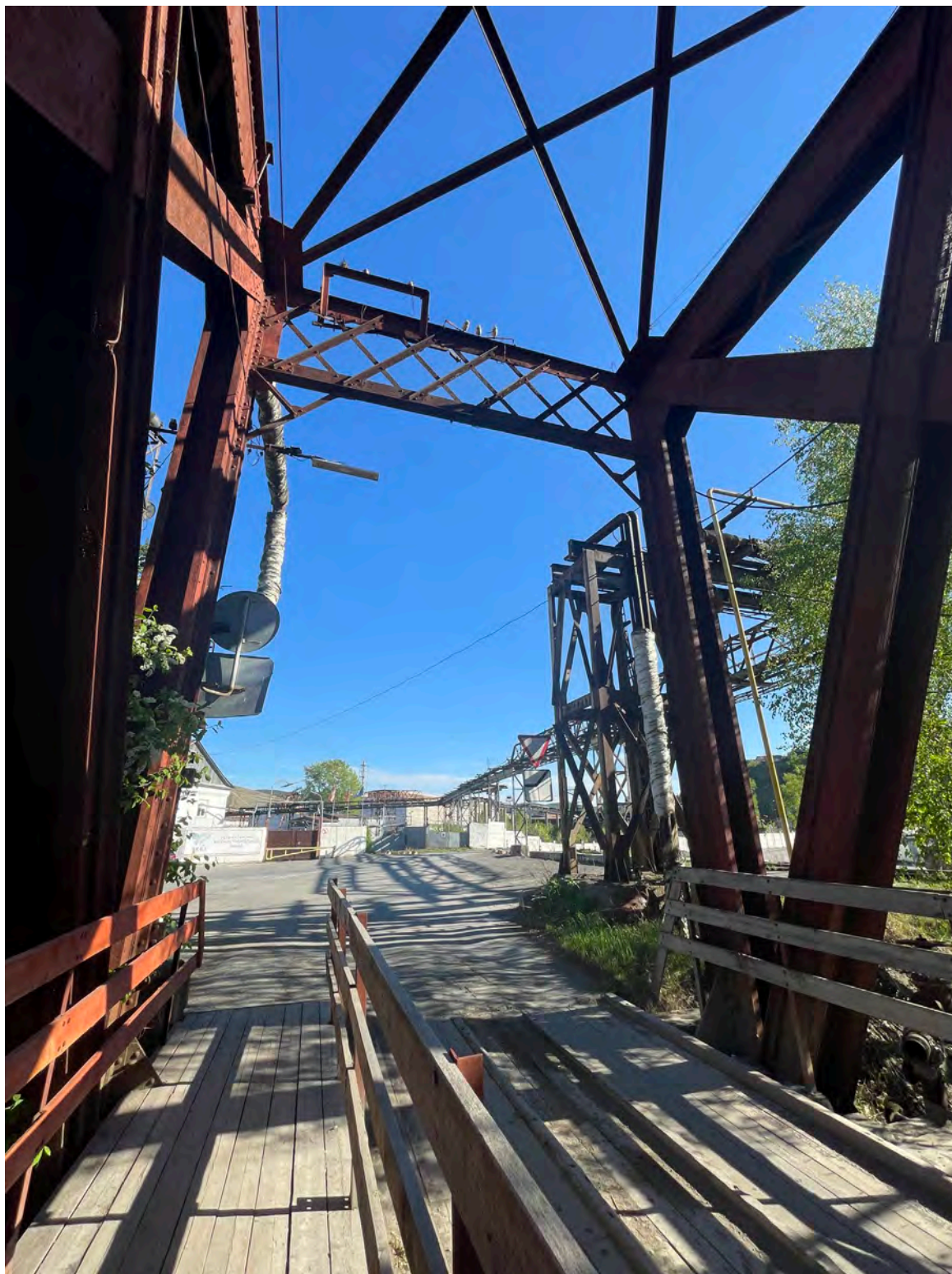
Фото.12. Вид на «Французский мост» расположенный по адресу: Усть-Катавский городской округ, г. Усть-Катав, р. Юрюзань, между УКВЗ и Пост-заводом.
