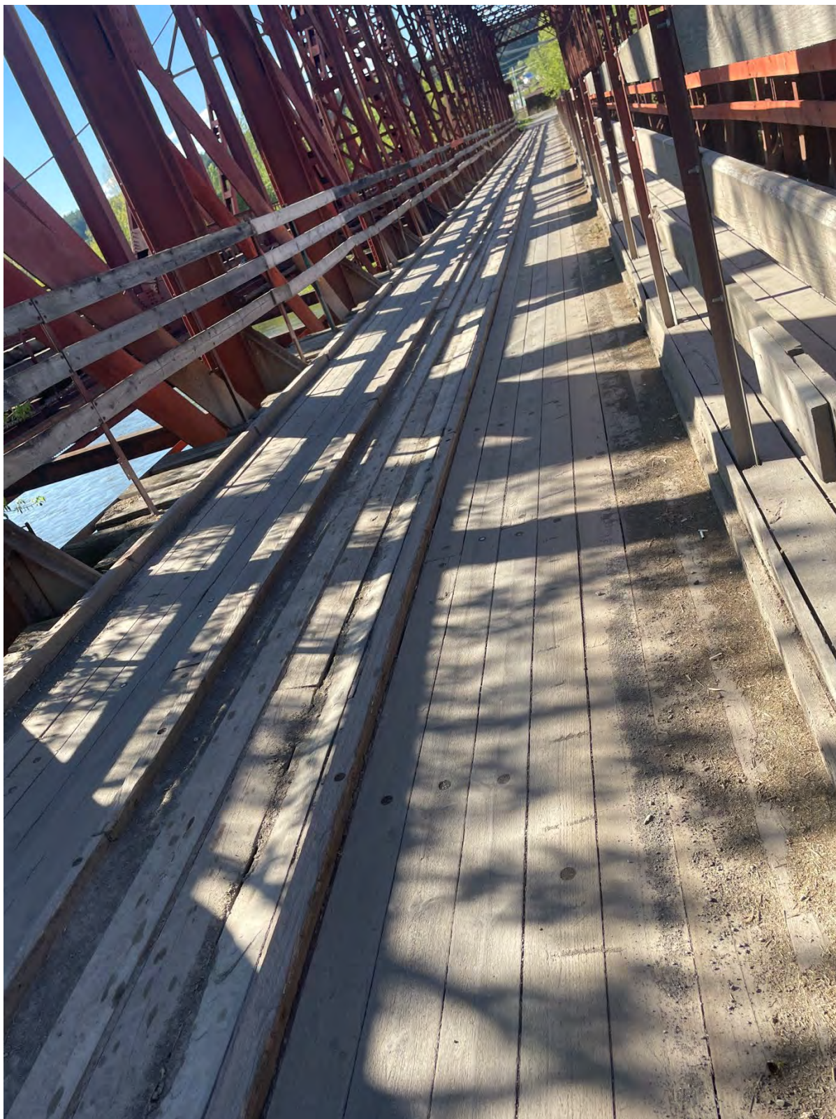
Фото.11. Вид на «Французский мост» расположенный по адресу: Усть-Катавский городской округ, г. Усть-Катав, р. Юрюзань, между УКВЗ и Пост-заводом.
