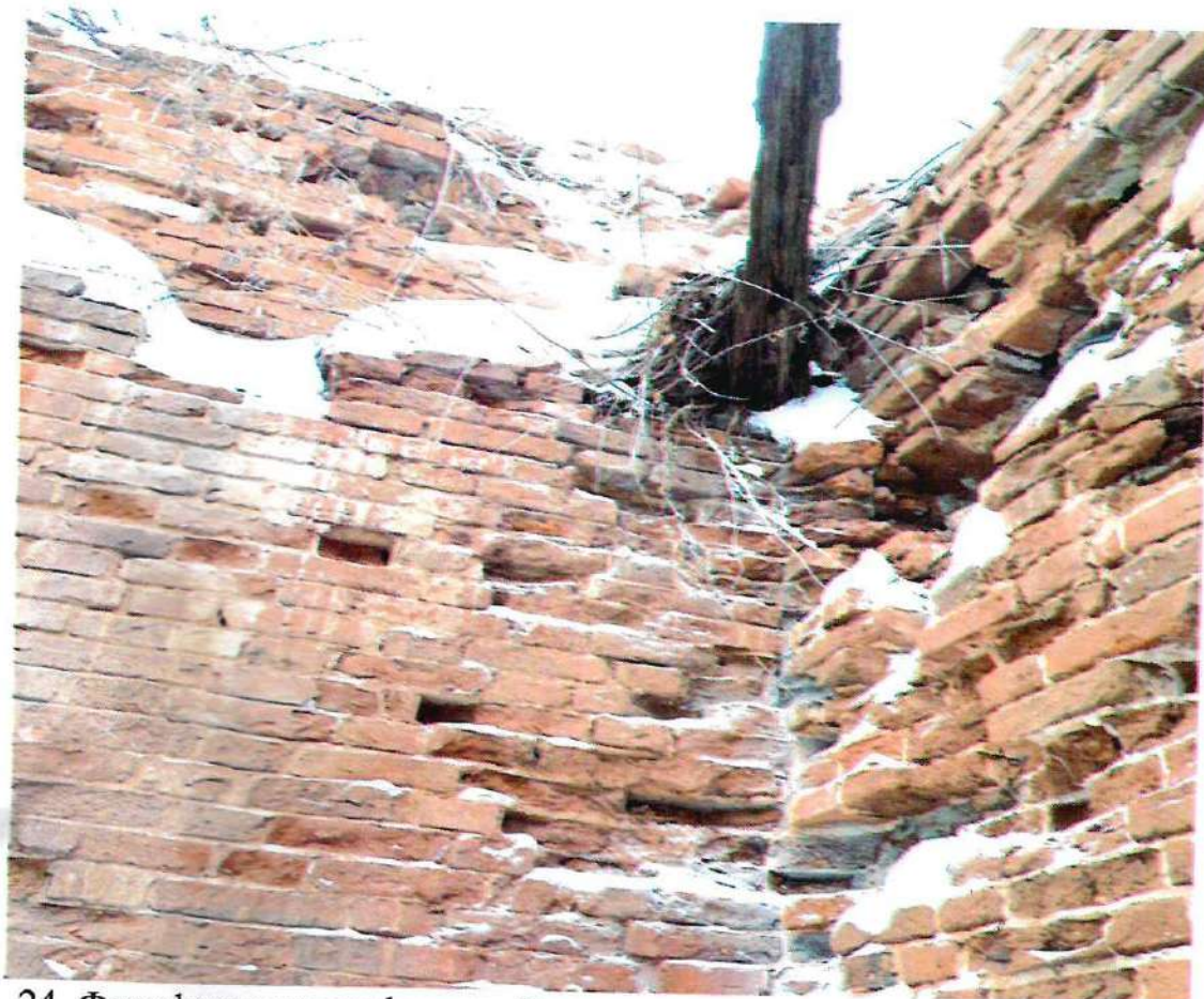
Рис. 24. Фотофиксация дефектов. Отсутствие кровли и глубокое структурное разрушение внутренней поверхности стен, местами выпадение кирпичей из кладки.
