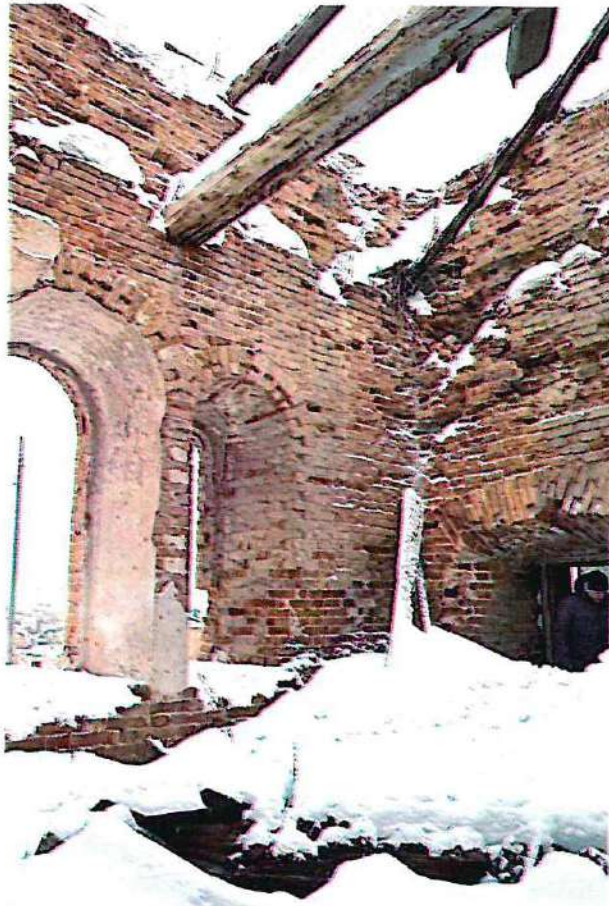
Рис. 26. Фотофиксация дефектов. Отсутствие оконных блоков, разрушение перекрытия, отсутствие стропильной системы кровли и покрытия, разрушение кирпича кладки стен.
