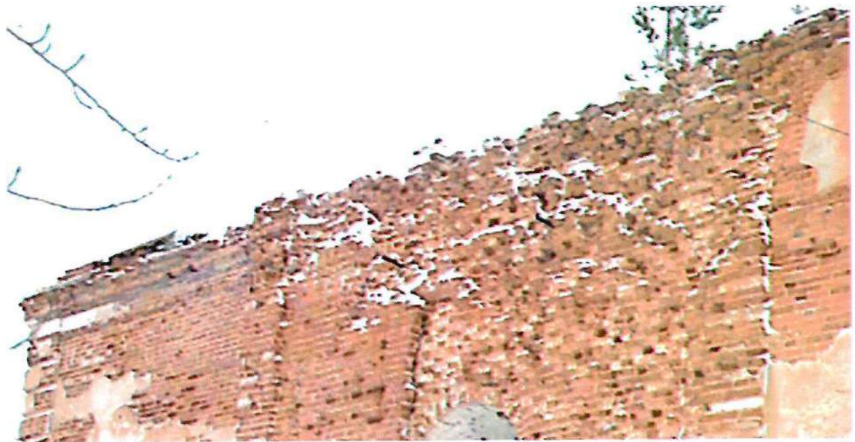
Рис. 16. Фотофиксация дефектов. Разрушение кирпичной кладки карнизной части стены.
