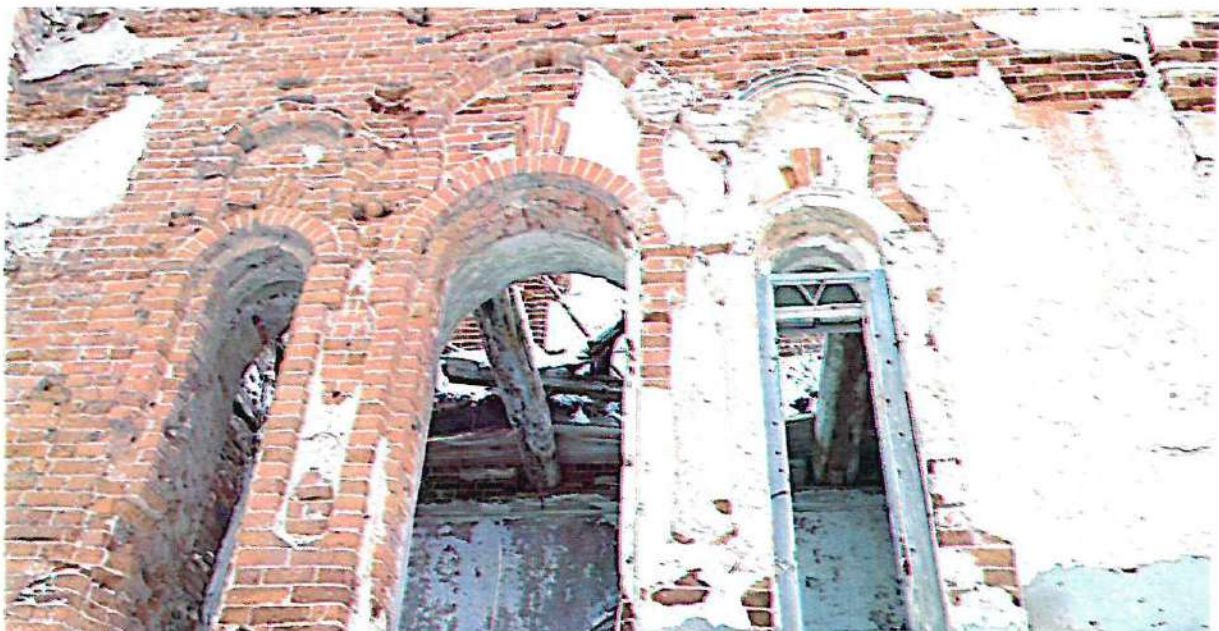
Рис. 18. Фотофиксация дефектов. Обрушение перекрытия, разрушение лицевой поверхности кладки, обрушение штукатурного слоя, утрата и разрушение лепного профилированного декора.
