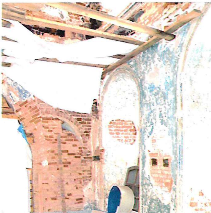
Рис. 19. Фотофиксация дефектов. Обрушение перекрытия, обрушение штукатурного слоя.
