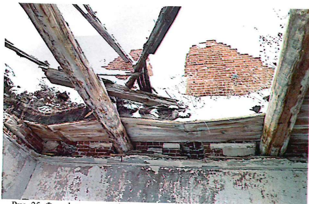
Рис. 25. Фотофиксация дефектов. Разрушение перекрытия, отсутствие стропильной системы кровли и покрытия.
