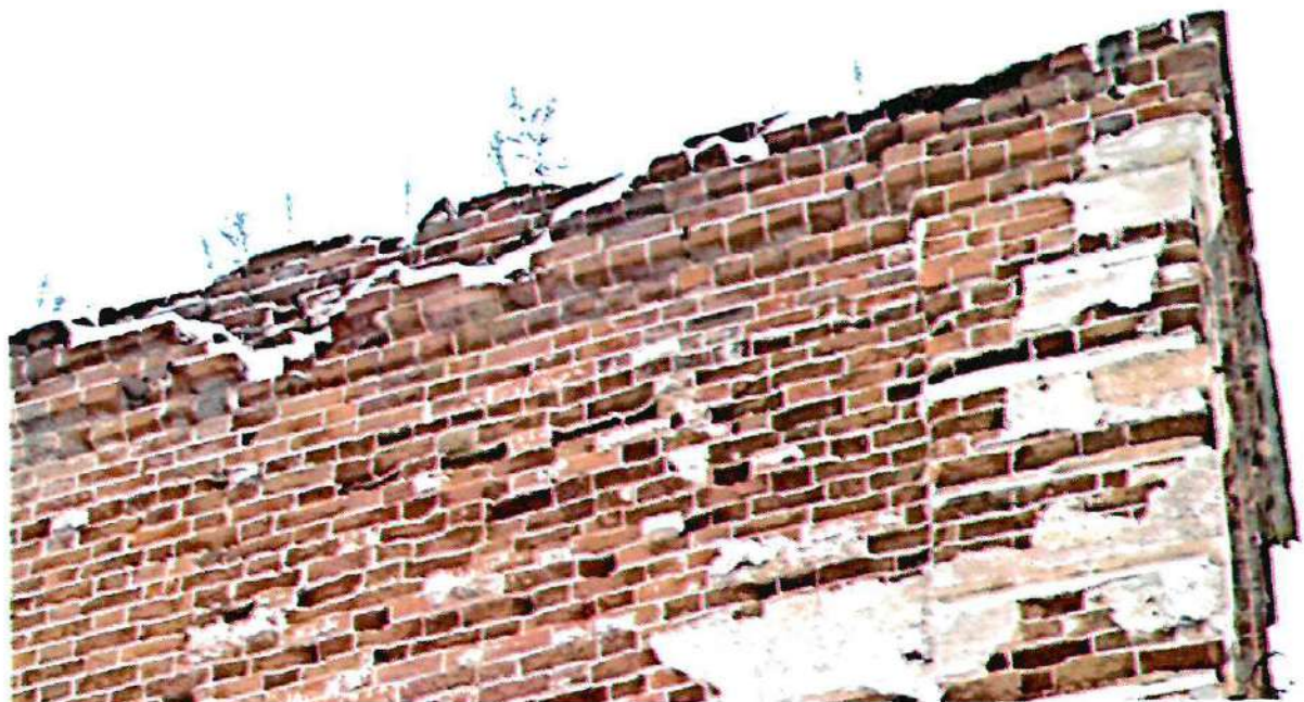
Рис. 17. Фотофиксация дефектов. Разрушение кирпичной кладки карнизной части стены.
