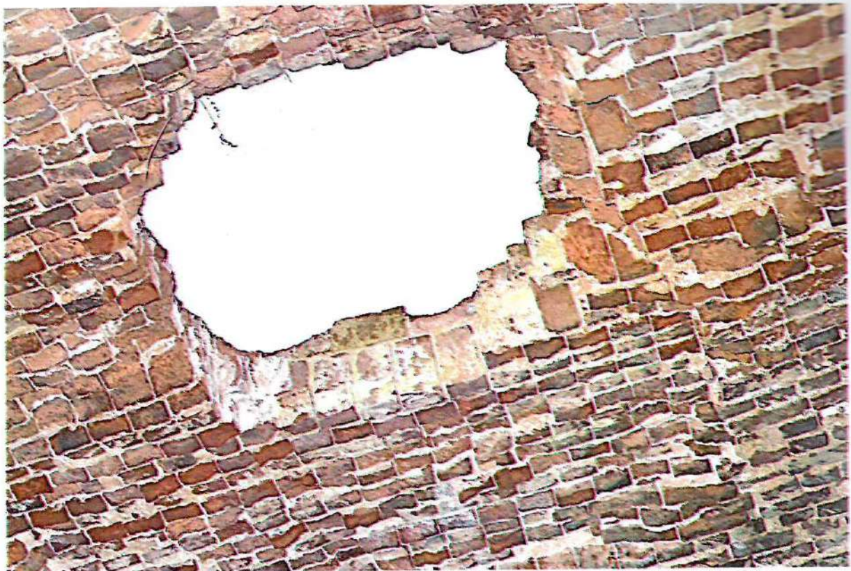
Рис. 28. Фотофиксация дефектов. Локальное обрушение свода, обрушение штукатурного слоя, повреждение кирпича кладки свода.
