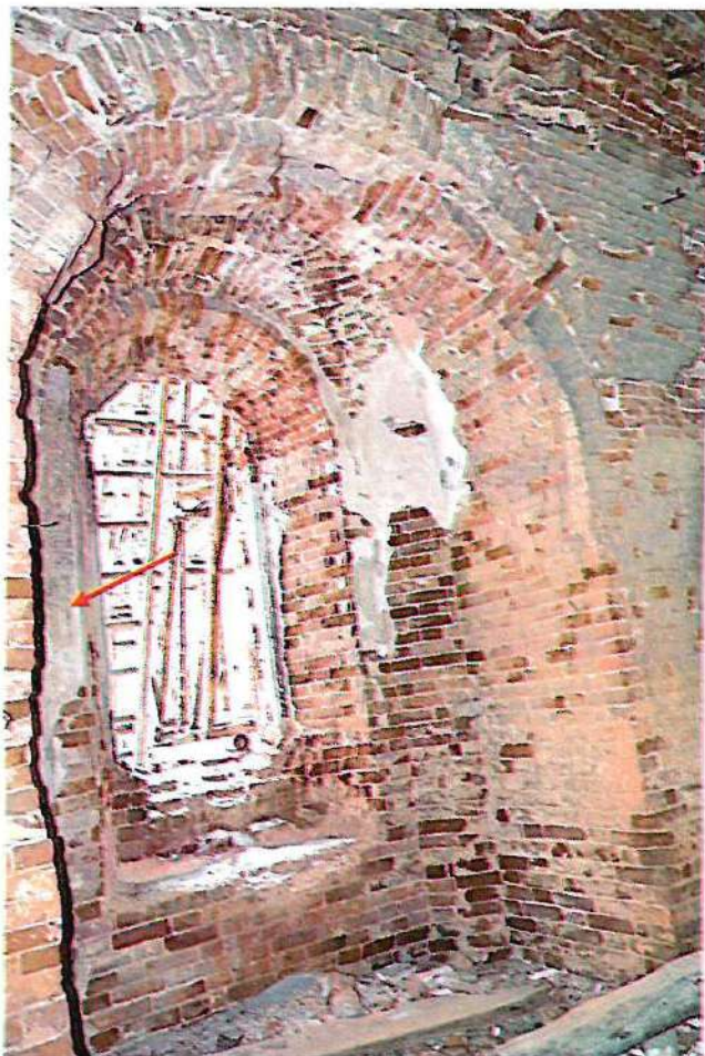
Рис. 22. Фотофиксация дефектов. Силловые трещины в кладке стены.
