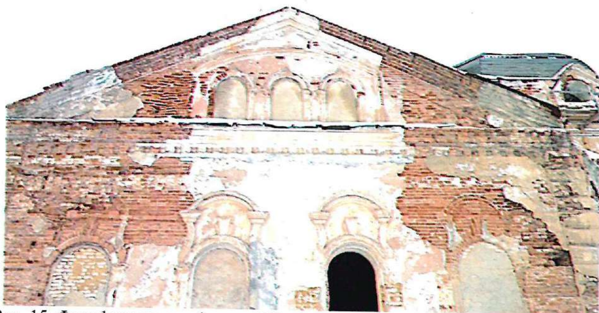
Рис. 15. Фотофиксация дефектов. Обрушение штукатурного слоя, разрушение архитектурного декора выполненного в ходе кладки, утрата лепного профилированного декора, заложенные первоначальные оконные проемы.
