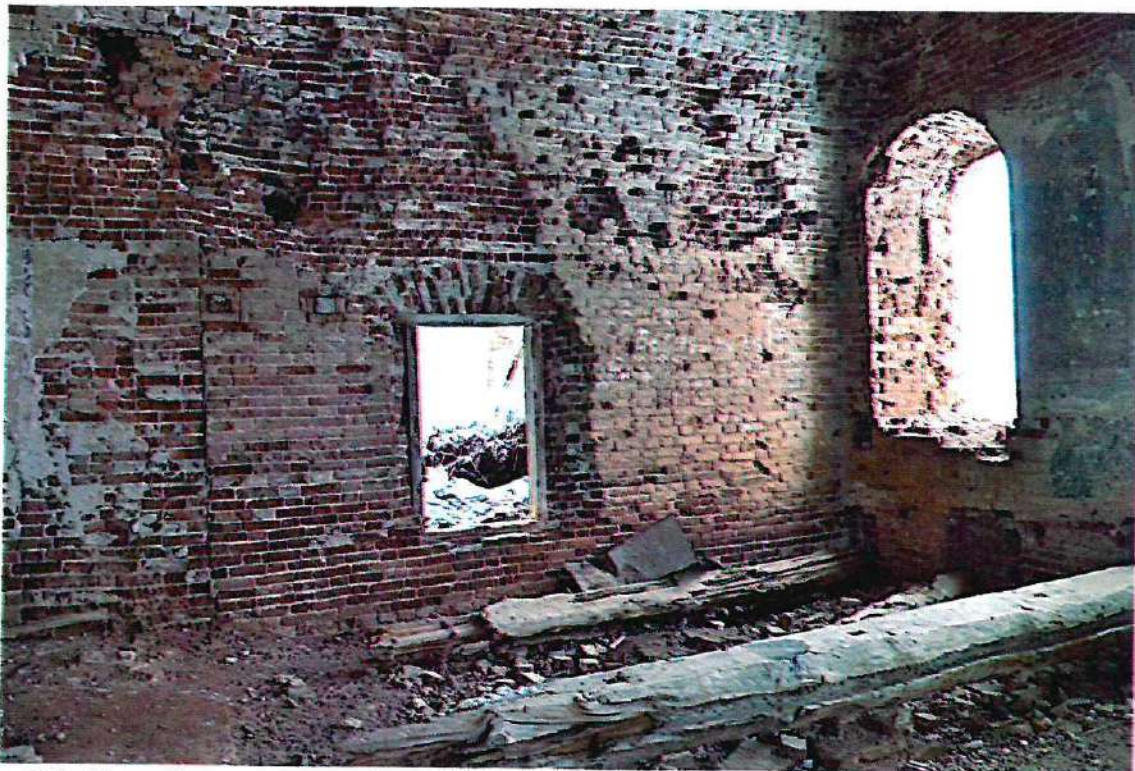
Рис. 27. Фотофиксация дефектов. Разрушение конструкции пола, обрушение штукатурного слоя, отсутствие оконных блоков, структурное разрушение кирпича кладки стен.
