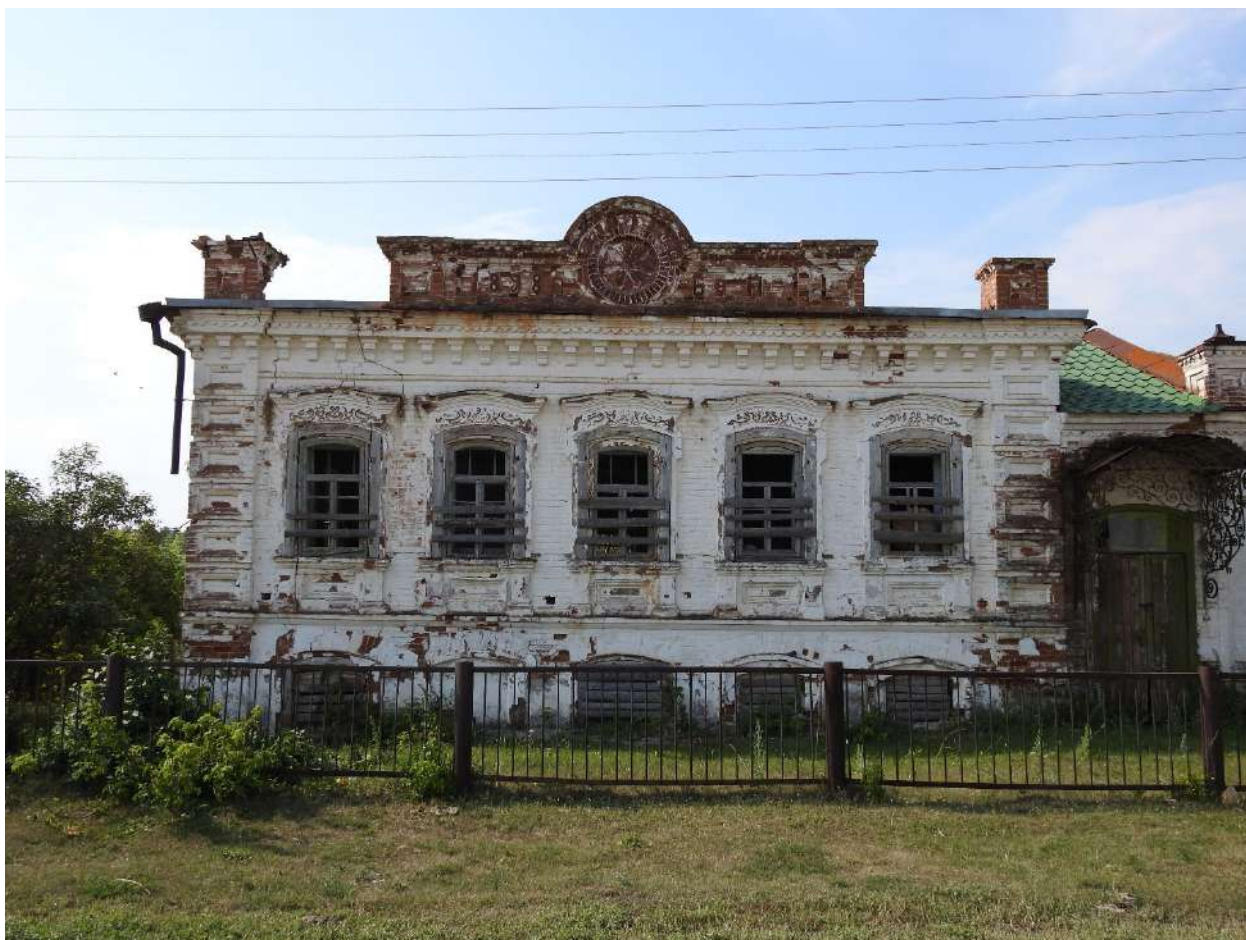
Фото 5. Вид на восточную часть парадного фасада Объекта с северной стороны по красной линии ул. Красногвардейской.
