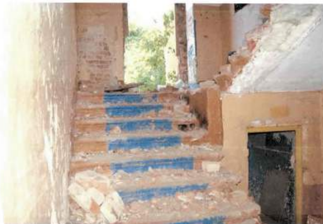
Фото 15. Вид на разрушенную южную лестничную клетку
