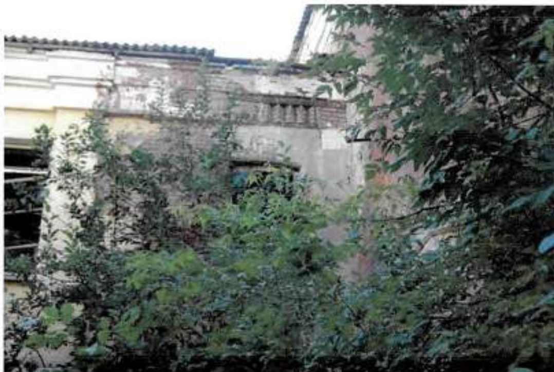
Фото 9. Вид на карнизную зону восточного фасада северного пристроя здания
