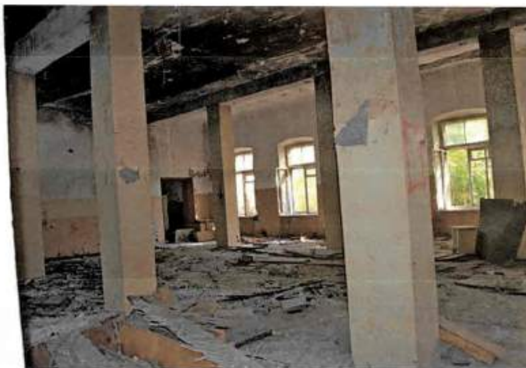
Фото 24. Вид на помещение 1-го этажа с северной стороны со следами копоти вследствие возгорания
