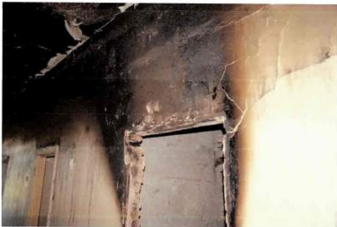
Фото 31. Вид на коридор 2-го этажа с юго-запада со следами копоти вследствие возгорания
