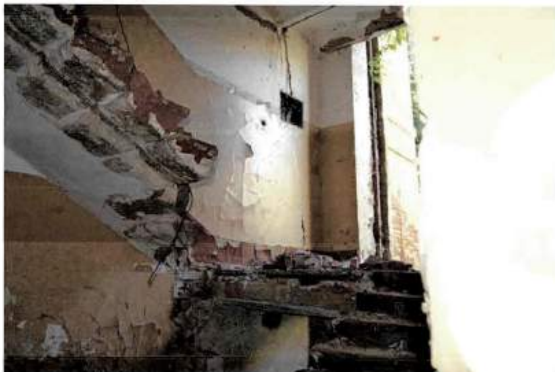
Фото 21. Вид на разрушенную северную лестничную клетку
