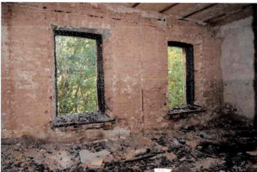
Фото 30. Вид на помещение 2-го этажа со следами копоти вследствие возгорания
