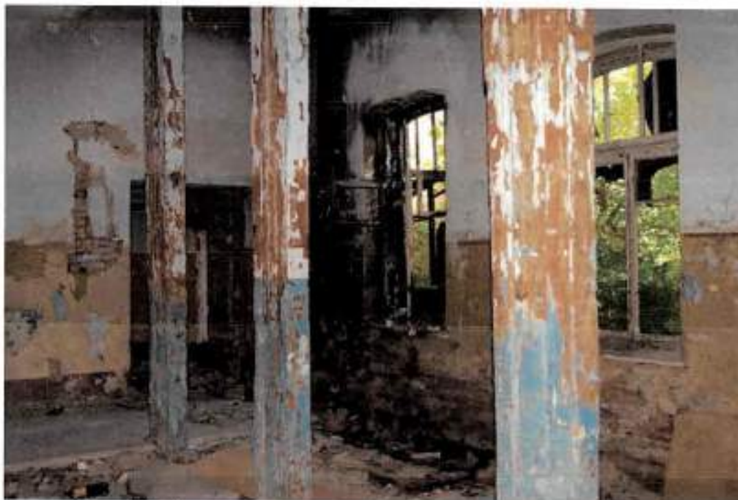
Фото 15. Вид на помещение 1-го этажа со следами копоти вследствие возгорания
