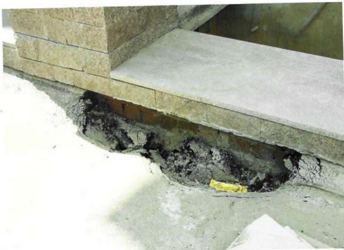
Фото 9. г. Челябинск, ул. Цвиллинга, 81 Выявленный объект культурного наследия «Кинотеатр имени 30-летия ВЛКСМ» Разрушение асфальтового покрытия в месте примыкания к стенке приямка
