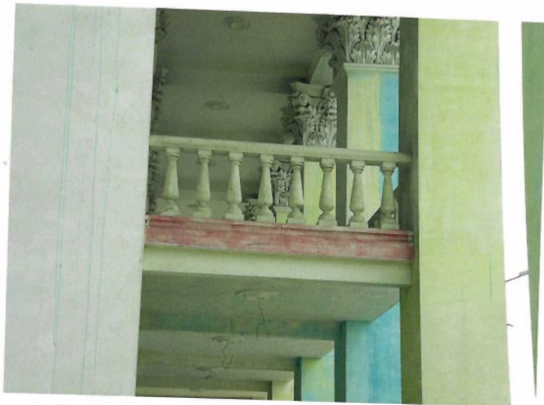
Фото 7. г. Челябинск, ул. Цвиллинга, 81 Выявленный объект культурного наследия «Кинотеатр имени 30-летия ВЛКСМ» Декоративное оформление колонн с балюстрадой
