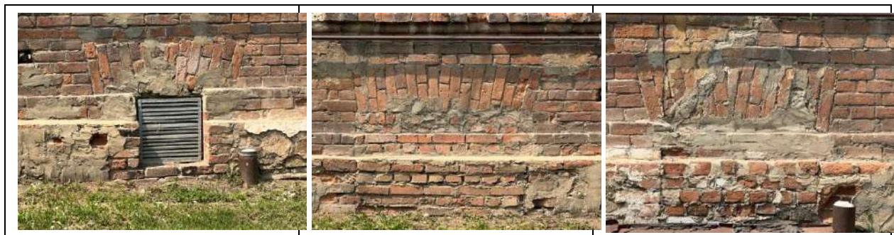
Рис. 4 а, б, в. Заложенные дверной и фланкирующие оконные проемы цокольного этажа главного фасада
