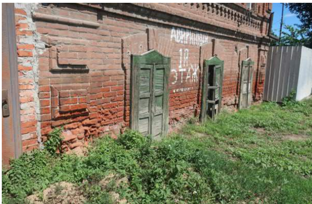
Фото 6. Фрагмент с окнами цокольного этажа южного парадного фасада Объекта. Фото сделано с западной стороны.
