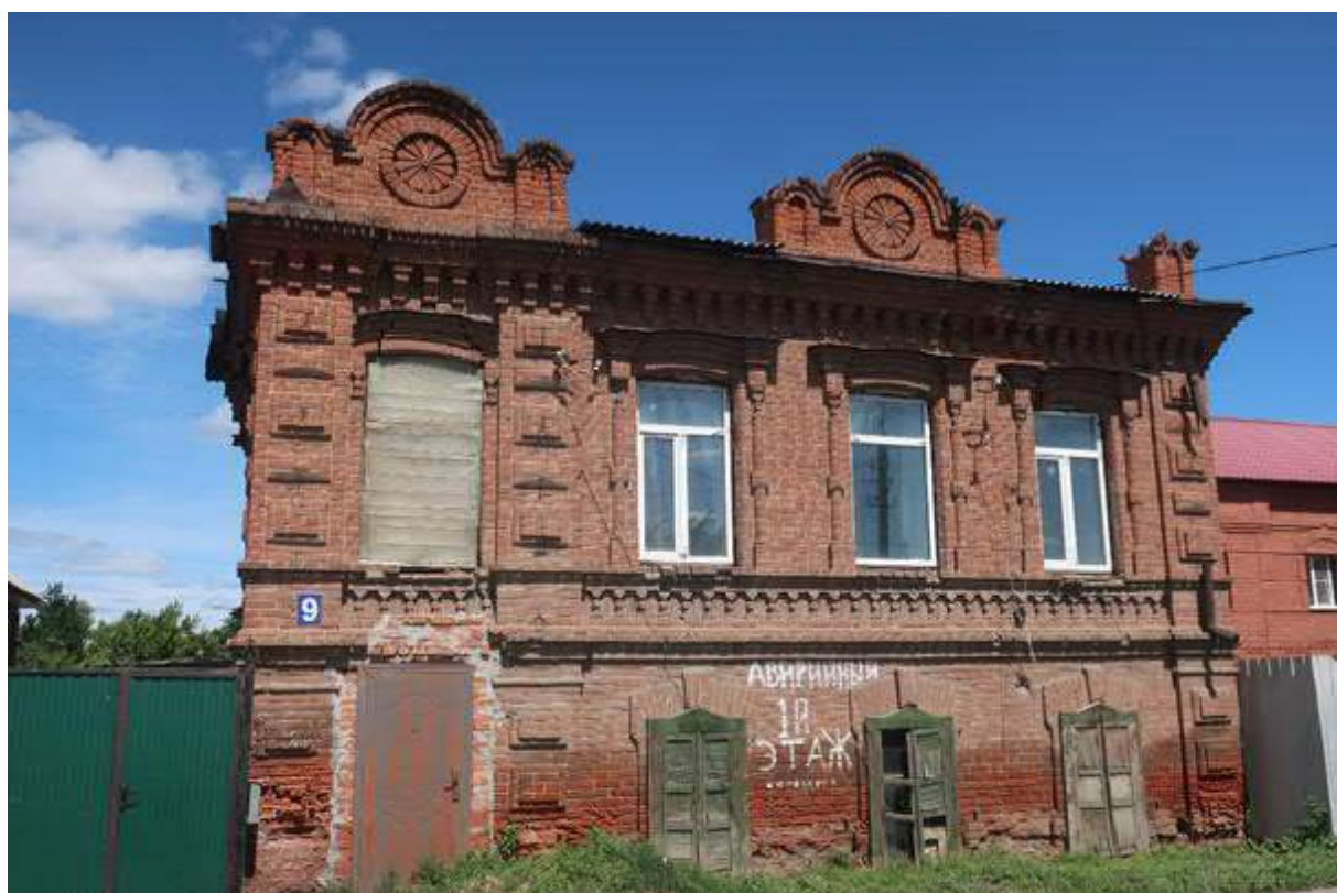
Фото 4. Вид южного парадного фасада Объекта, расположенного по красной линии нечетной стороны ул. им. В.И. Чапаева.
