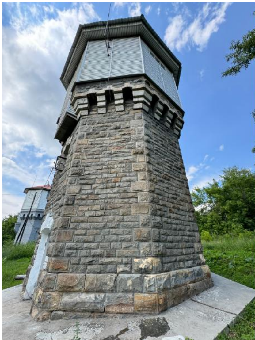
Фото 14. Вид на выявленный объект культурного наследия «Водонапорная башня-1», расположенный по адресу: Челябинская область, Миасский городской округ, г. Миасс, ж/д ст. Миасс-1.
