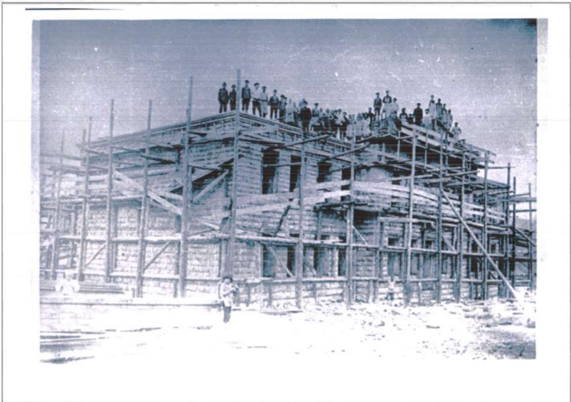
Из фонда краеведческого музея г. Катав-Ивановска. Строительство двухэтажного начального народного училища. 1913 год.
