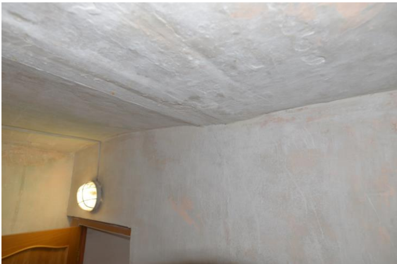
Фото 30. Интерьер выявленного объекта культурного наследия «Городской особняк», расположенного по адресу: Челябинская область, Троицкий городской округ, г. Троицк, ул. им. Степана Разина, 10.
