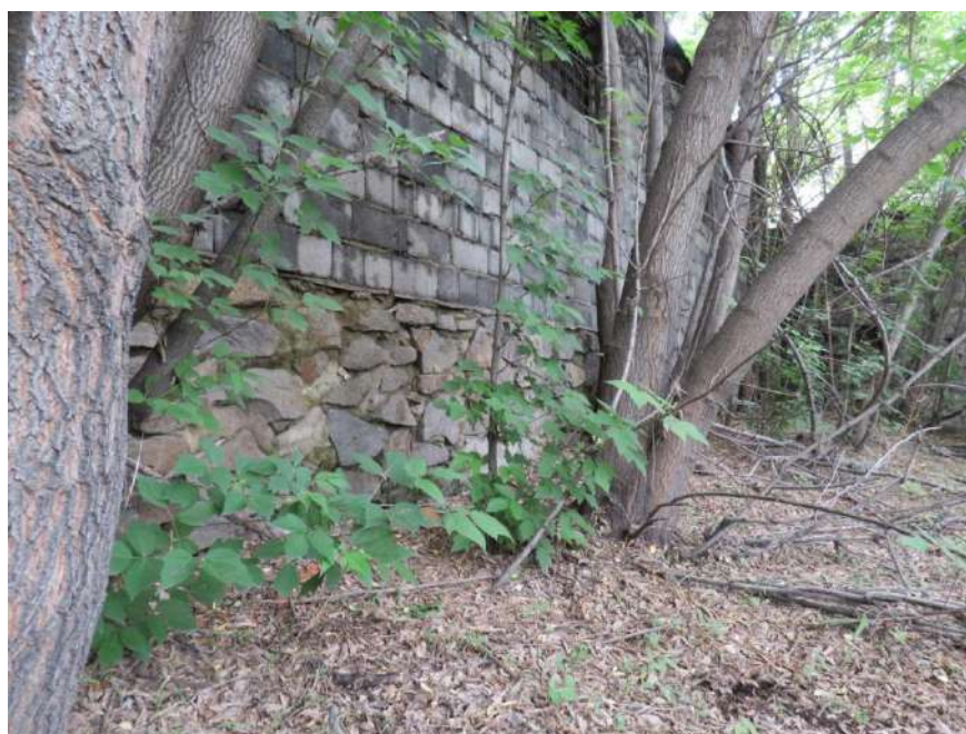
Рис. 8. Вид западной стены производственного здания нижней частью которой является историческая бутовая кладка с опорным контрфорсом
