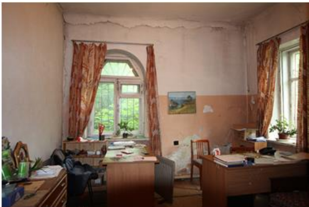
Интерьер. Трещины в месте примыкания перекрытия к стене и перегородки к стене.
