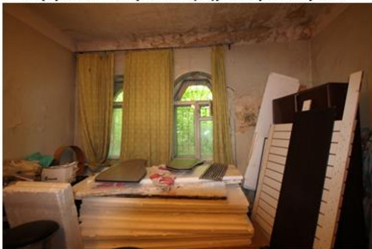
Множественные протечки на потолке. Разрушение красочного и штукатурного слоёв на стенах
