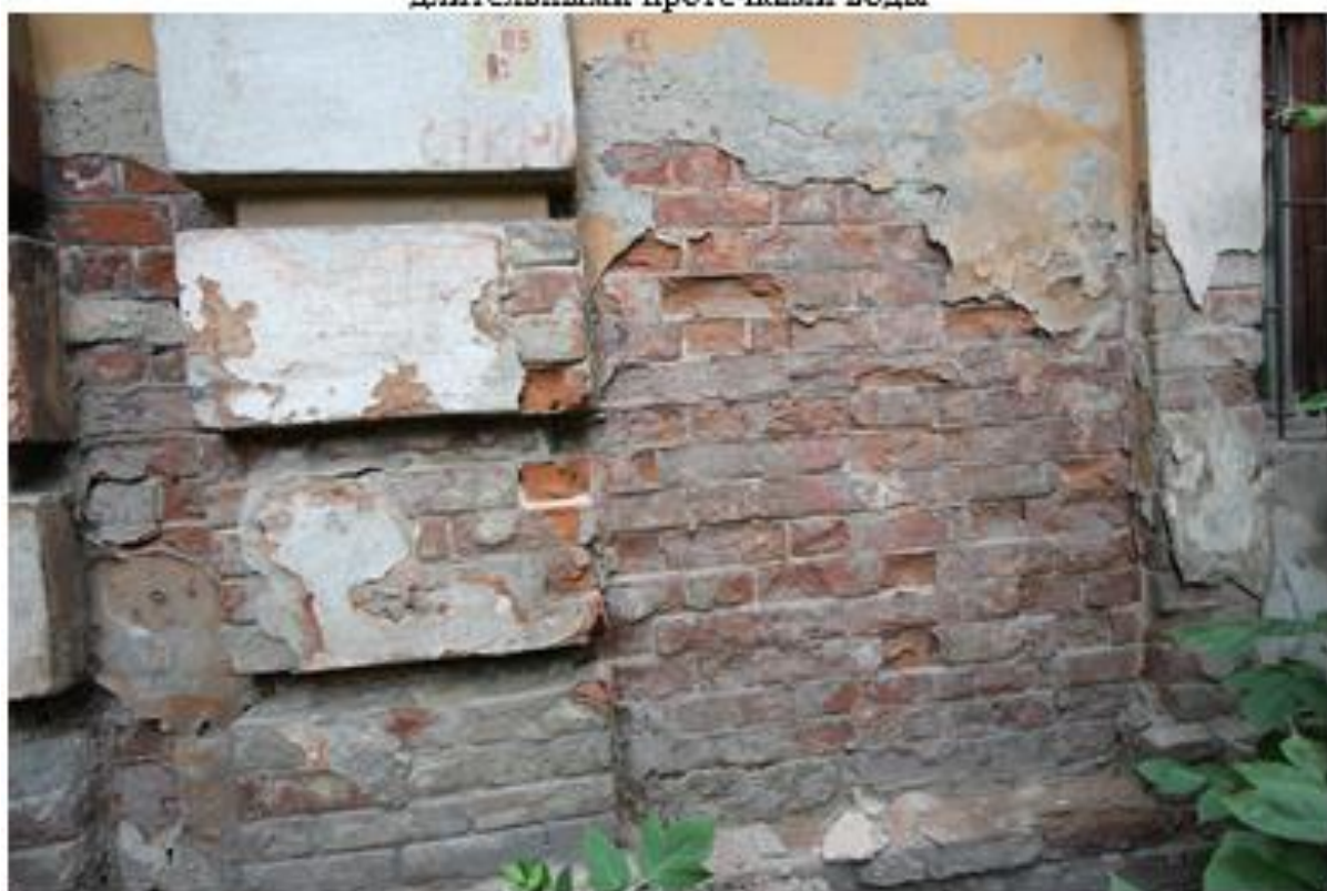
Состояние кирпичной кладки. Разрушения вызваны оштукатуриванием цементосодержащим составом
