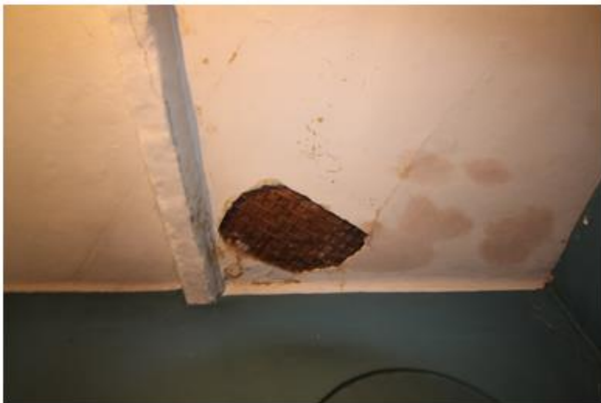
Разрушение штукатурной обработки потолка. Обнажение дранки и подшивной доски.
