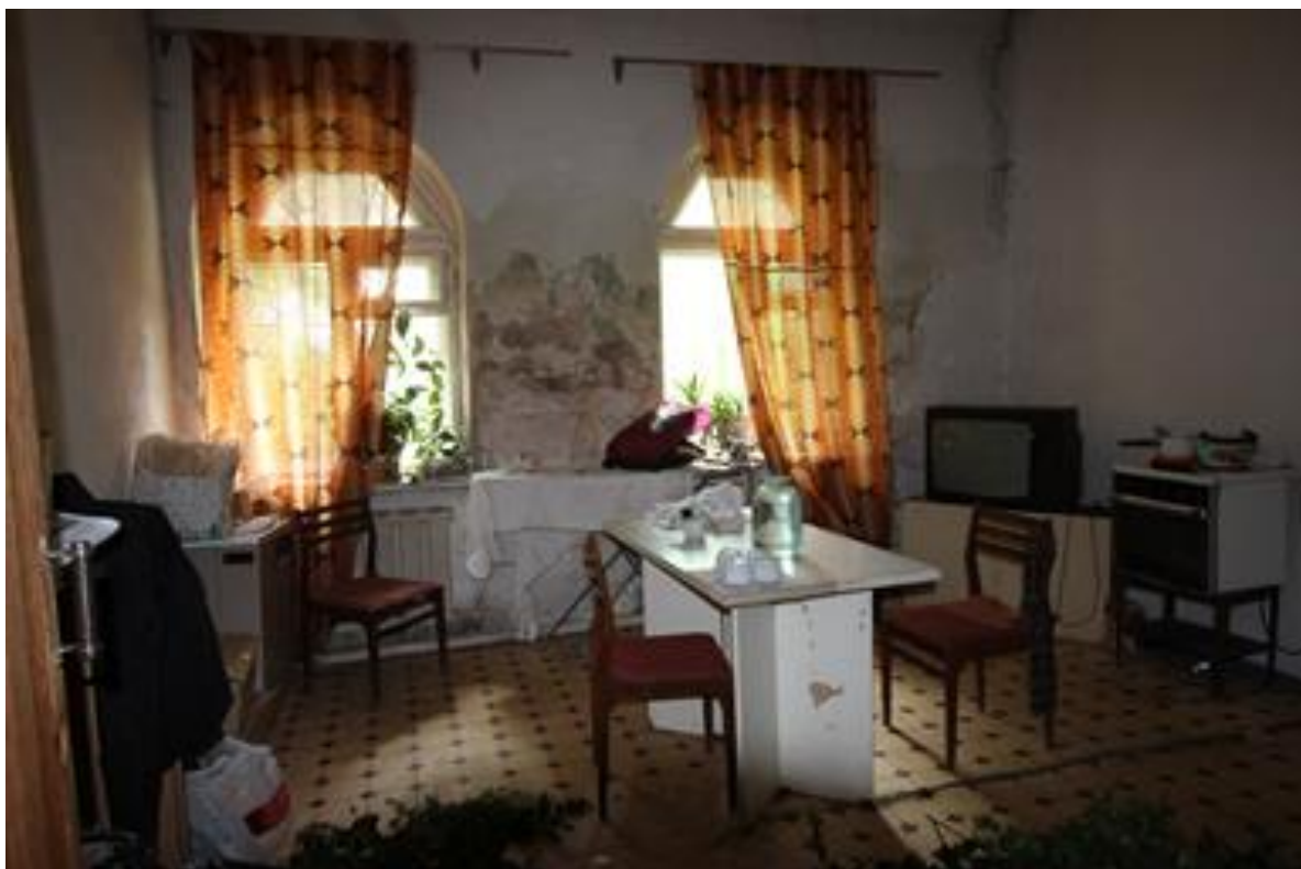
Интерьер. Множественные трещины по штукатурке стен. Грибковые поражения
