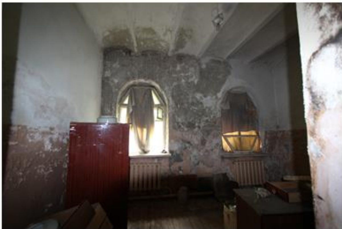
Своды "Монье". Аварийное состояние отделки стен, потолка, пола.
