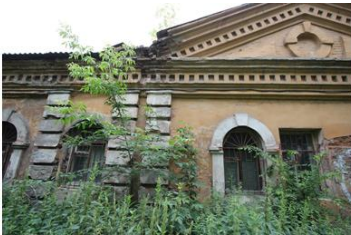
Фрагмент северо-западного фасада. Разрушение карниза фронтона, вызванное длительными протечками воды
