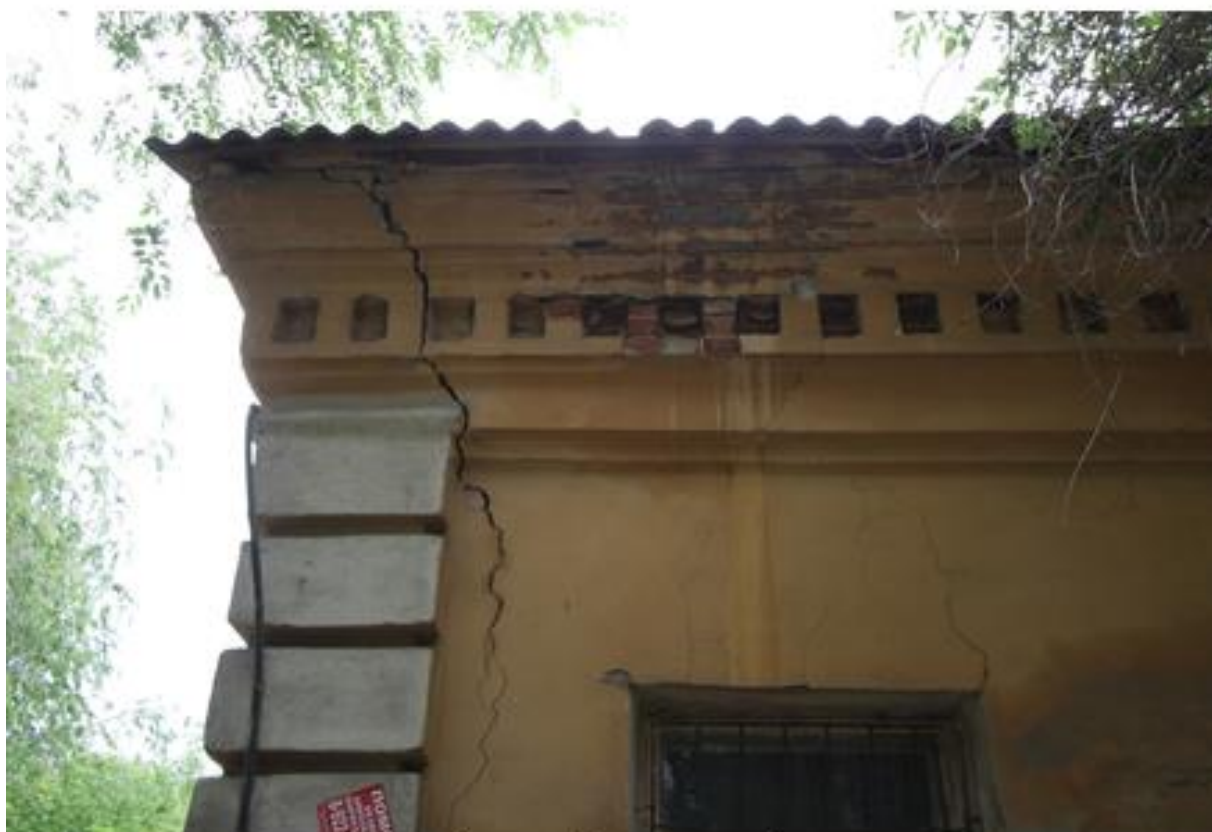
Фрагмент юго-западного фасада. Проседание фундамента - трещина по кирпичной стене
