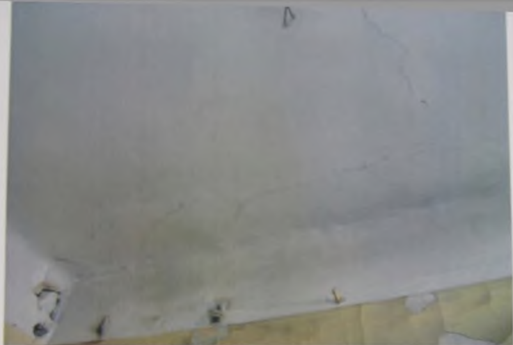
Рис. 29. Множественные трещины в перекрытии второго этажа
