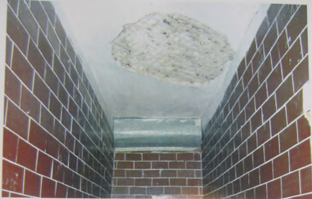
Рис.21. Разрушение штукатурного слоя потолка на первом этаже
