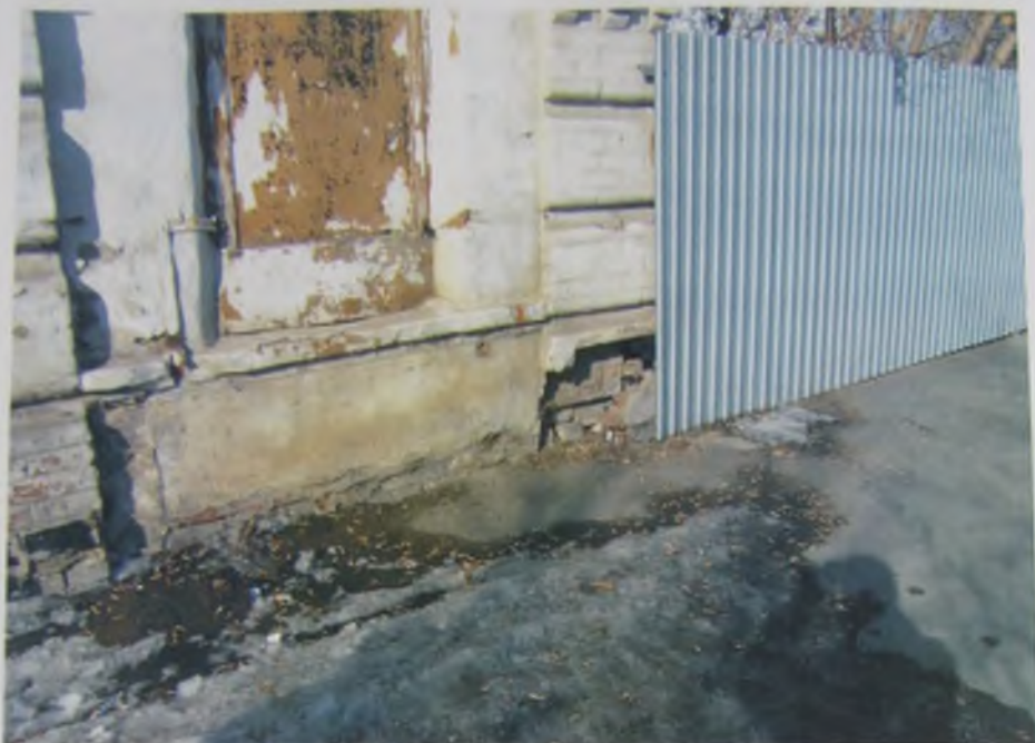
Рис.11. Фрагмент восточном фасада с разрушением штукатурного слоя и пилястры
