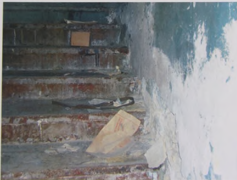
Рис.24. Разрушение штукатурного слоя лестничной площадки. Коррозия металла ступеней
