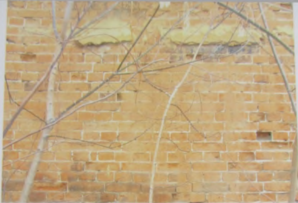
Рис.17. Фрагмент северного фасада, намокание стены вследствие отсутствия организованного водостока
