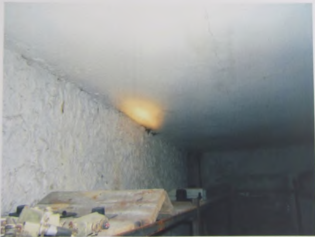
Рис.22. Продольная трещина в перекрытии подвала
