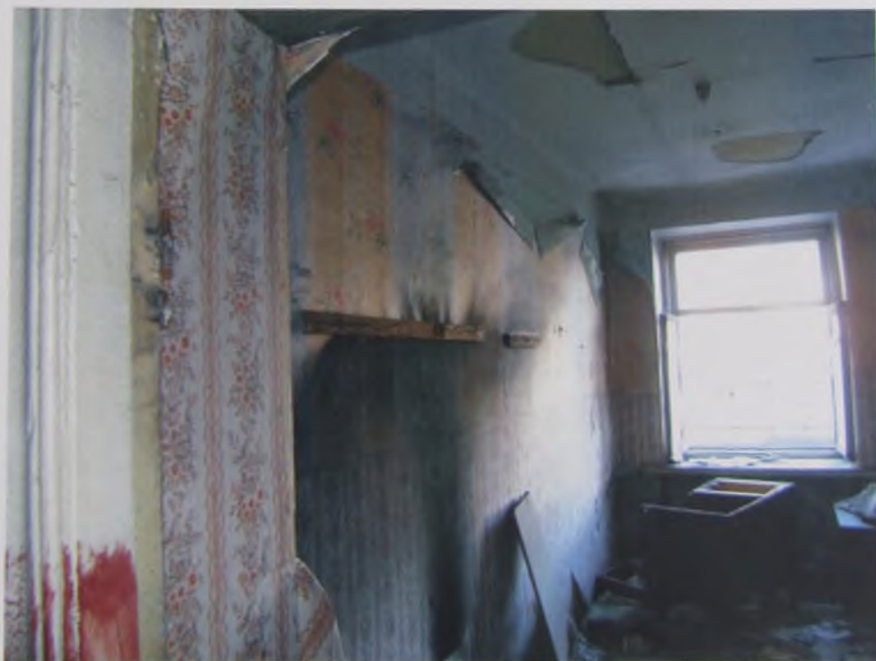
Рис.20. Обрушение штукатурного слоя потолка. Множественные трещины в штукатурном слое
