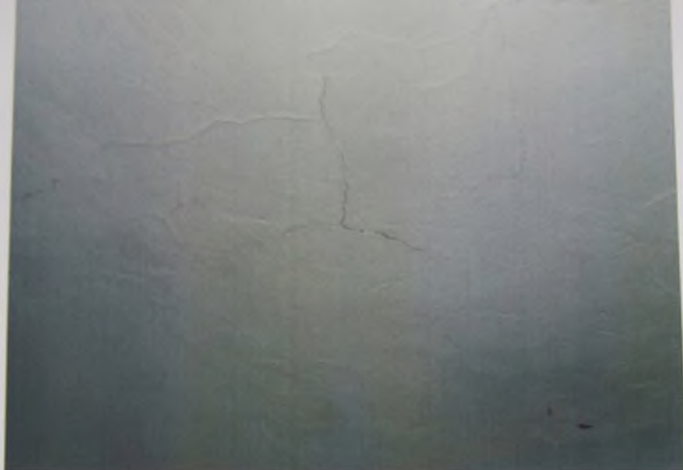
Рис.23. Множественные трещины в перекрытии
