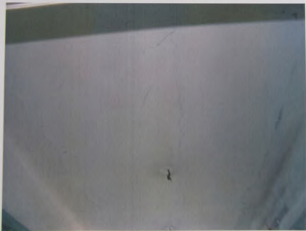
Рис.28. Продольные трещины в перекрытии второго этажа
