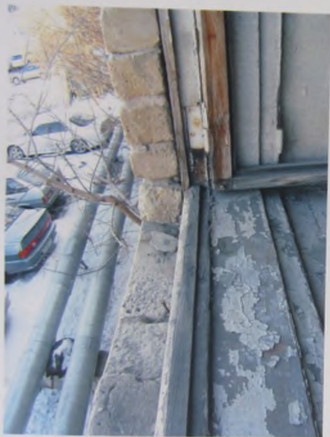
Рис.15. Разрушение кирпича. Выщелачивание раствора
