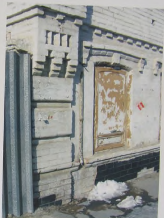
Рис.16. Фрагмент восточного фасада с разрушением штукатурного слоя и отделки цоколя
