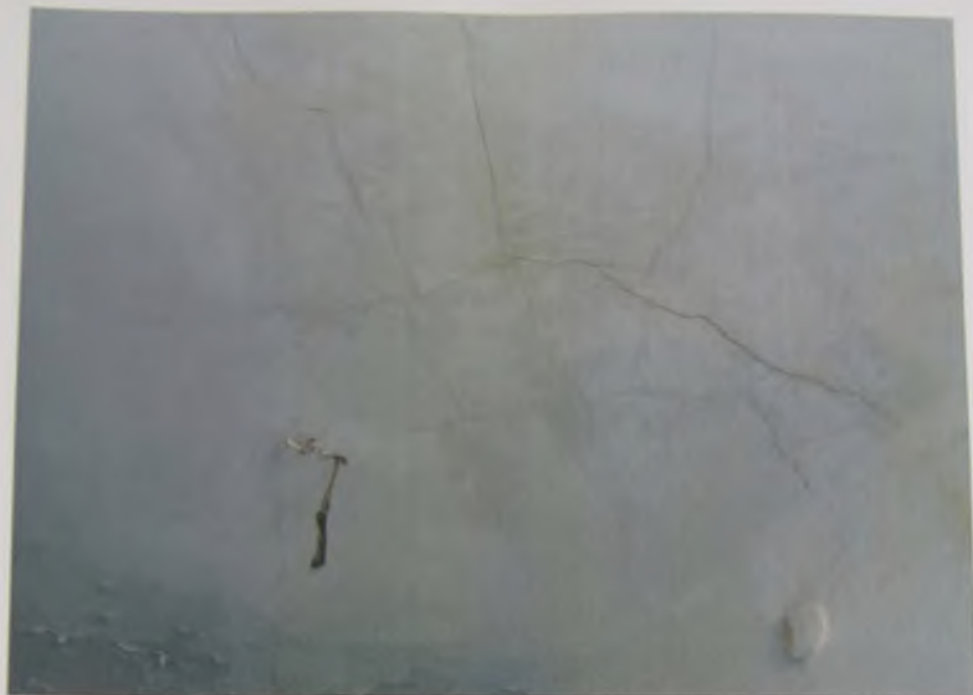
Рис.31. Множественные трещины в перекрытии второго этажа
