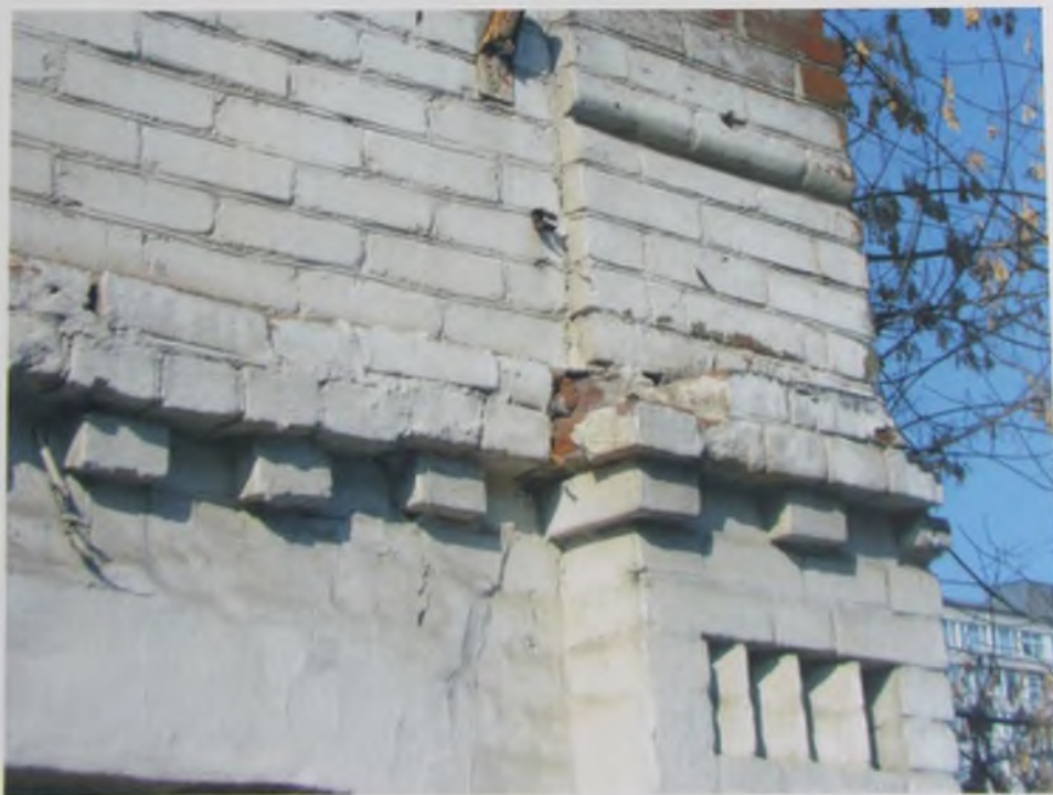
Рис.12. Фрагмент восточном фасада с разрушением пилястры
