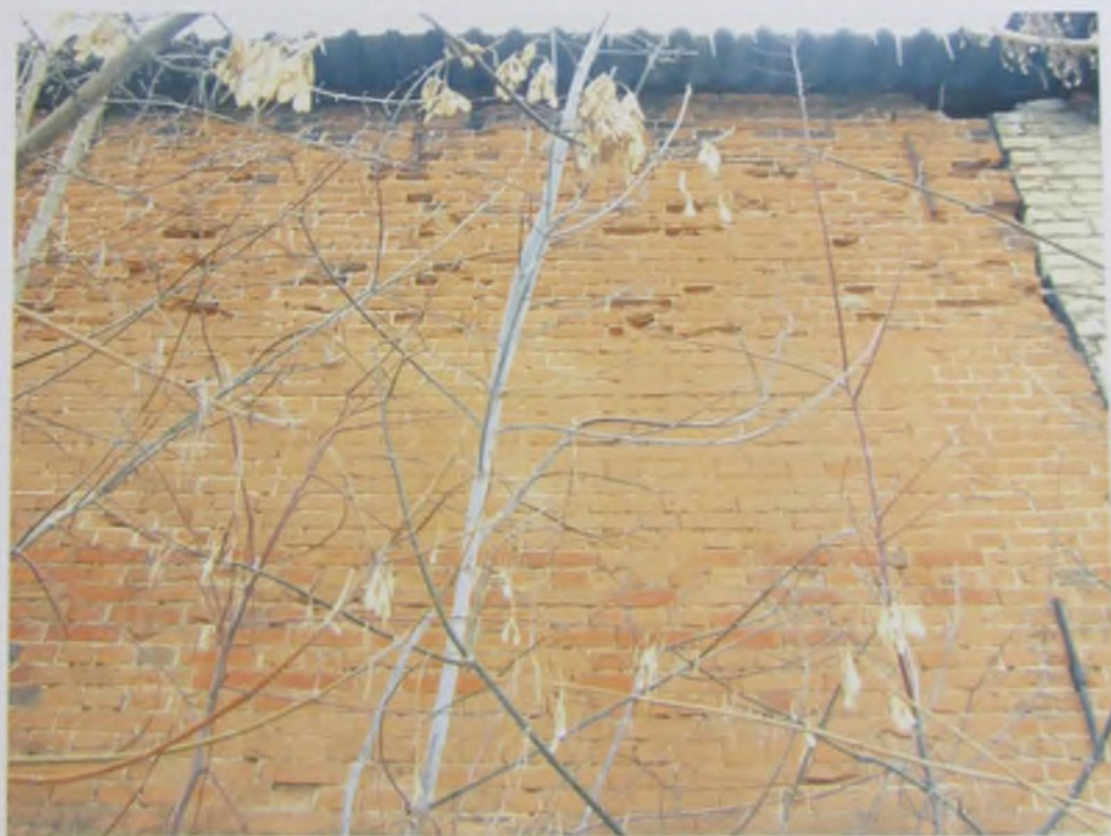
Рис.18. Выкрашивание кирпичной кладки вследствие намокания и промерзания. Выщелачивание раствора. Вертикальная трещина.
