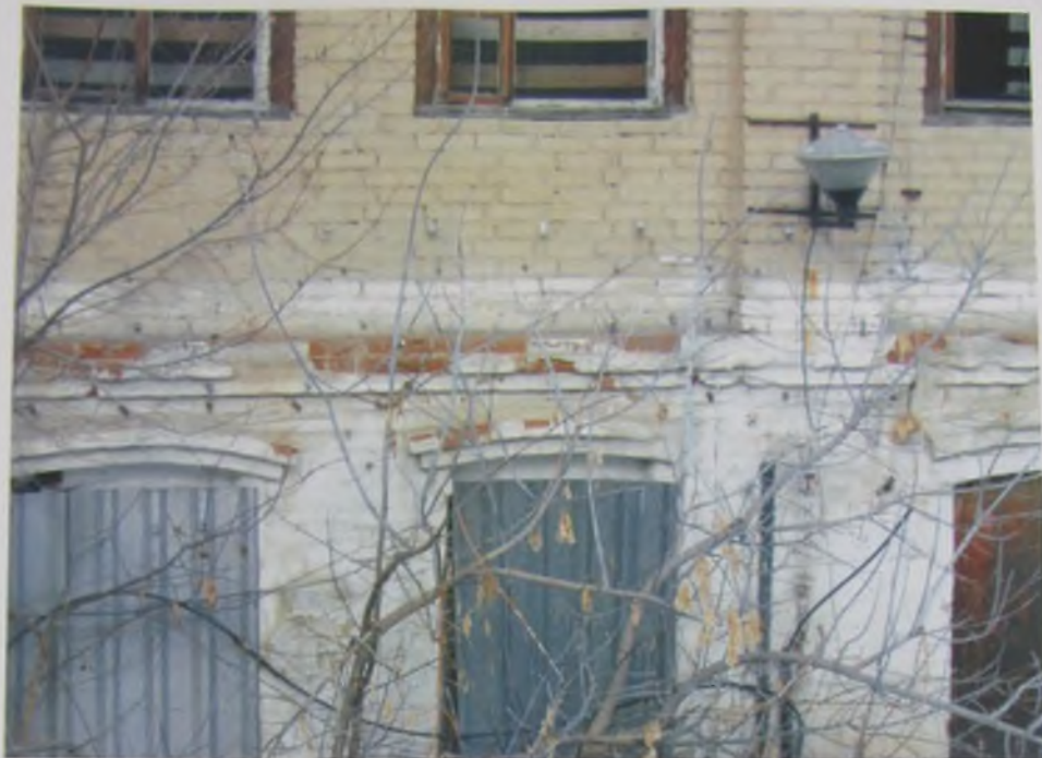
Рис.19. Разрушение растворного и штукатурного слоев вследствие намокания. Выкрашивание кирпичной кладки
