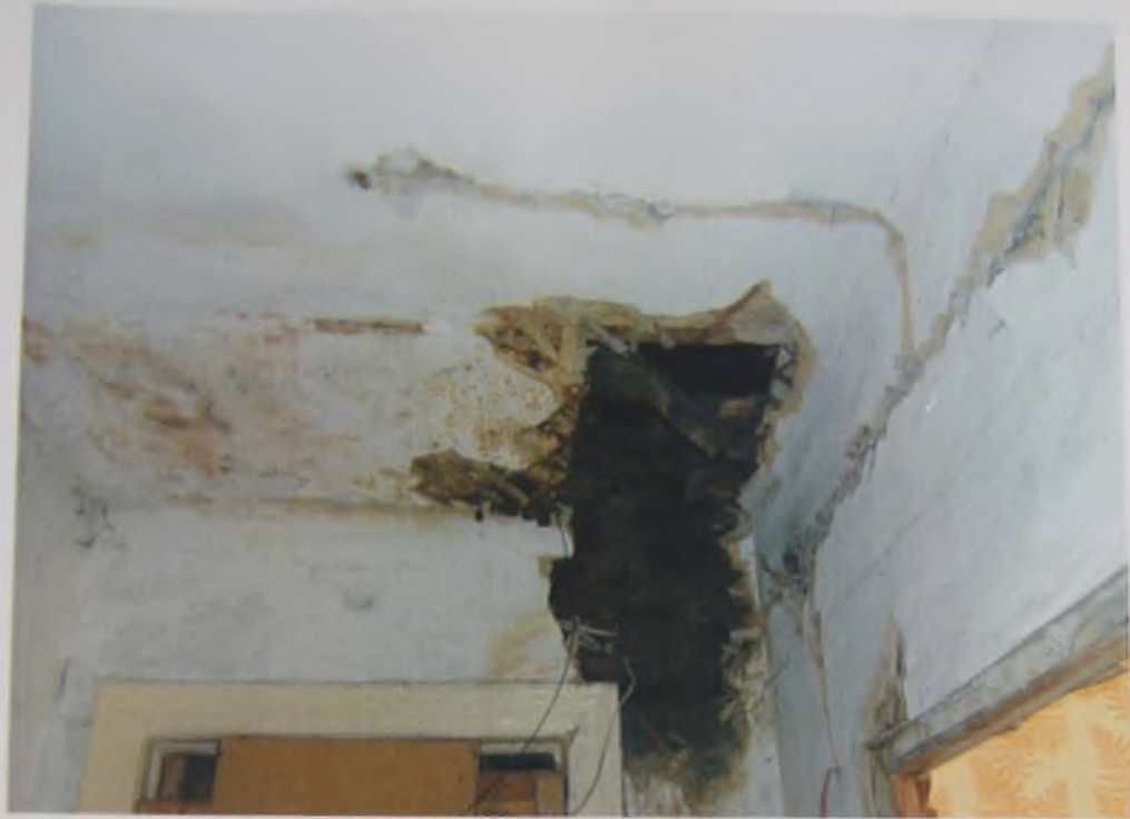
Рис.27. Обрушение перекрытия на втором этаже
