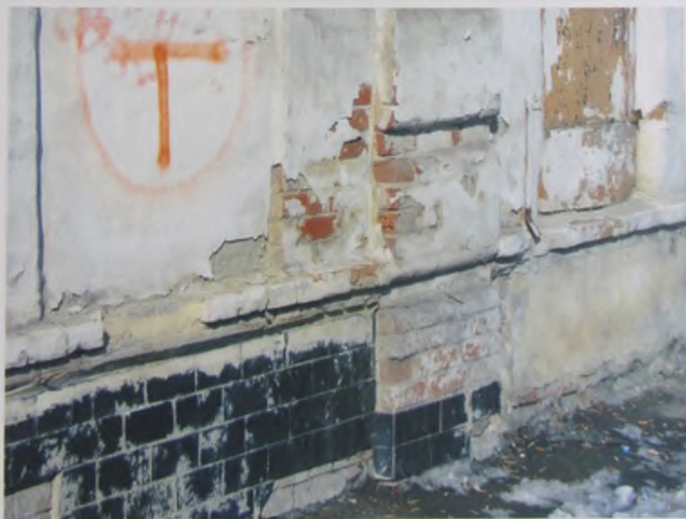
Рис.14. Разрушение растворного и окрасочного слоев цоколя, выкрашивание кирпичной кладки вследствие намокания
