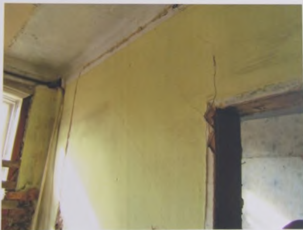
Рис.26. Множественные наклонные трещины в стене второго этажа
