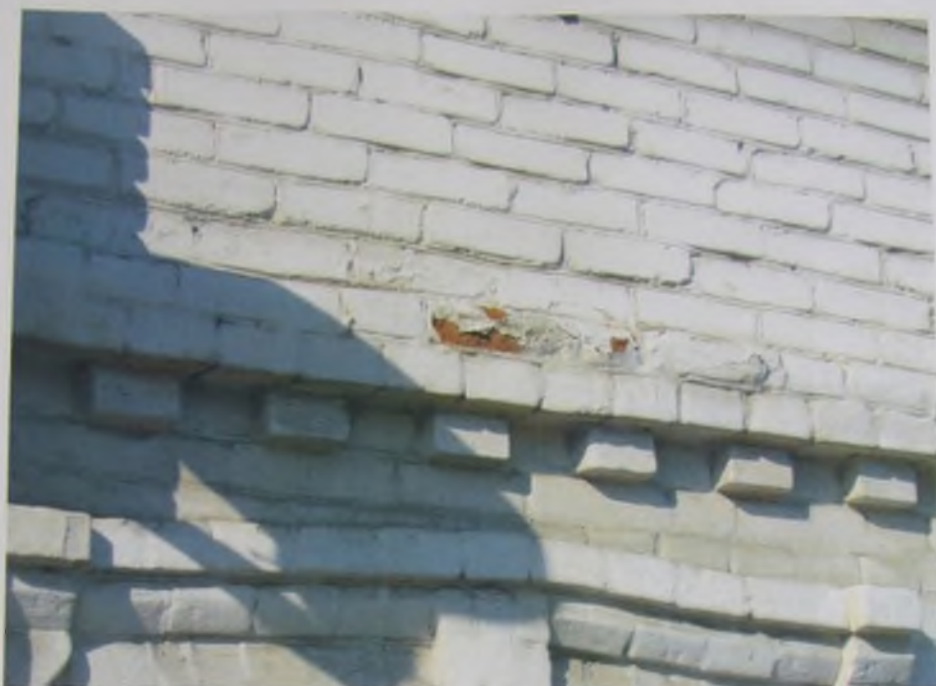
Рис.13. Фрагмент восточного фасада с разрушением кирпича
