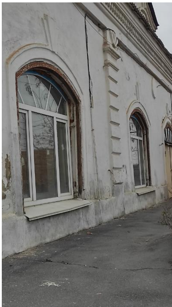
Фото 9. Вид на выявленный объект культурного наследия «Дом жилой», расположенный по адресу: Челябинская область, Миасский городской округ, г. Миасс, пл. Труда.
