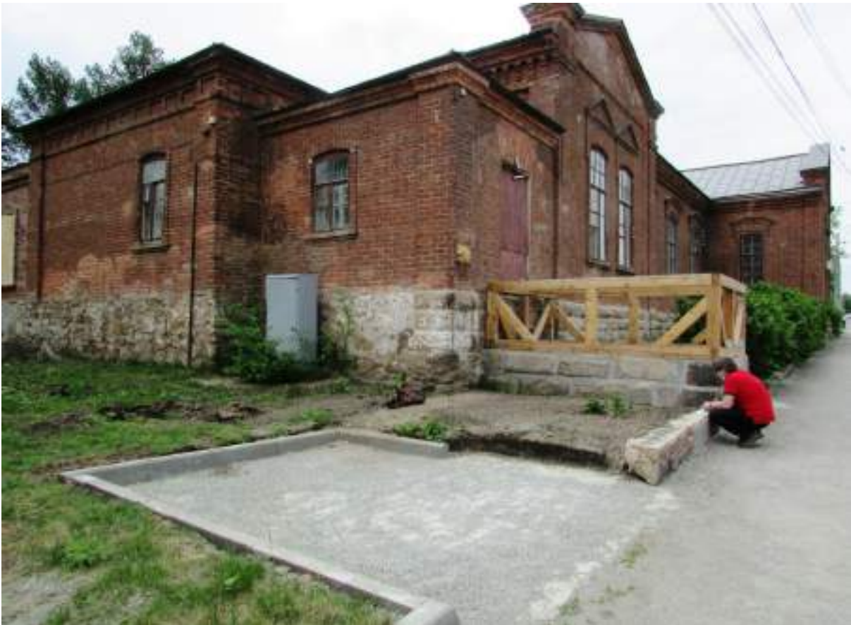
Рис.5. Вид на угловую часть северо-восточного и северо-западного фасадов здания-памятника с воссоздаваемой главной входной группой с ул. Воровского (фото авторов, май 2020 г.).
