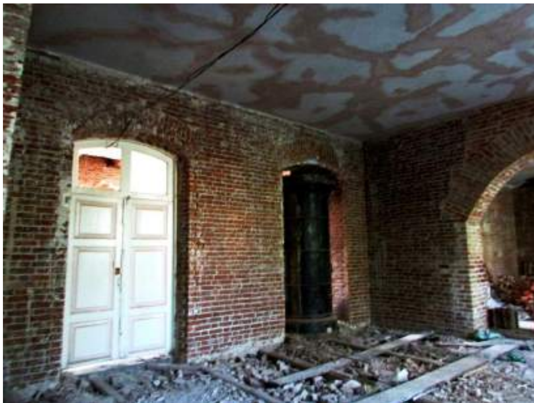
Рис.34. Вид на центральное восточное помещение с расчищенным лучковым проемом с голландской печью, с расчищенным большим арочным проемом и сохранившейся филенчатой деревянной дверью (фото авторов, май 2020 г.).
