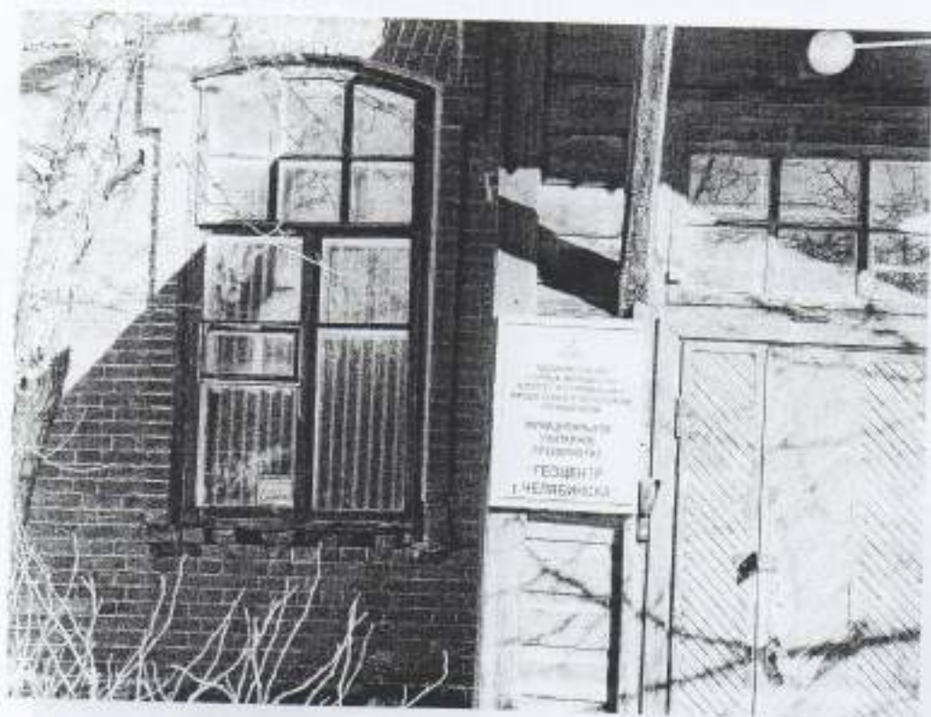
Фото 10. Фрагмент западного фасада здания (разрушение кирпичной кладки в нижней части оконного проема)
