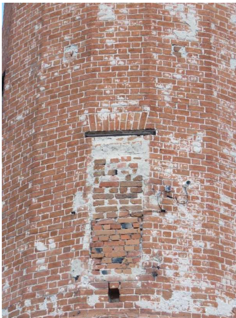
Рис. 10. Ствол минарета. Заложенный проем выхода на балкон
