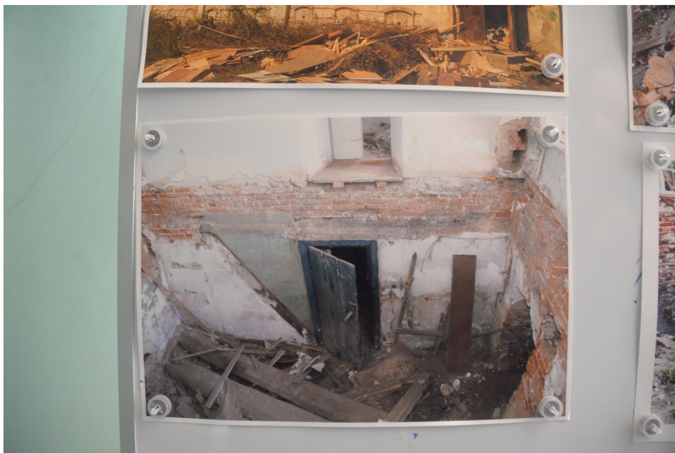
Фото 34. Интерьер выявленного объекта культурного наследия «Усадебный комплекс», расположенного по адресу: Челябинская область, Троицкий городской округ, г. Троицк, ул. Октябрьская, 83.
