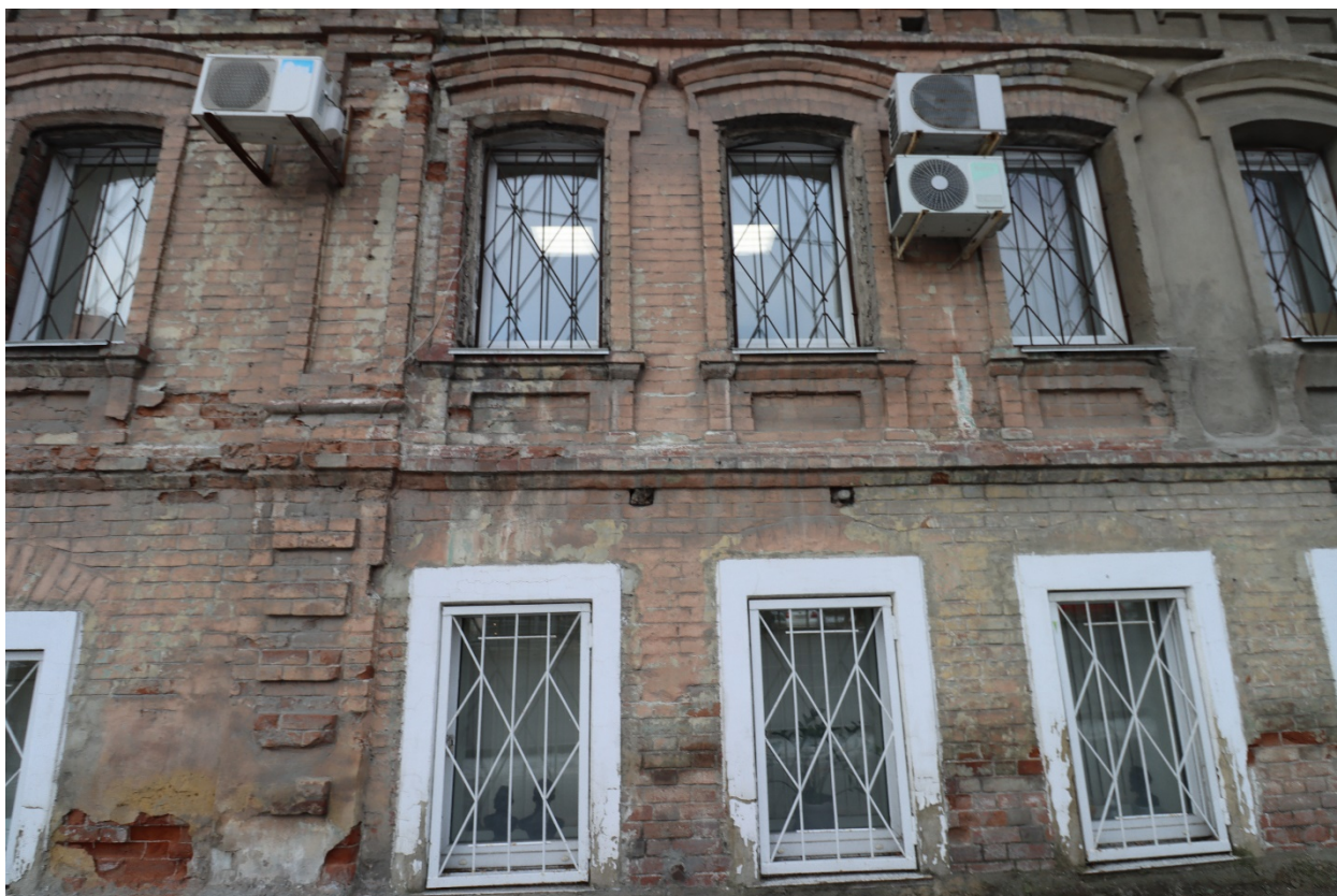
Фото.11 Выявленный объект культурного наследия «Дом Загуменного Ф. (низшая ремесленная школа)», расположенный по адресу: Челябинская область, г. Челябинск, ул. 1 Мая, 38. Северный фасад.
