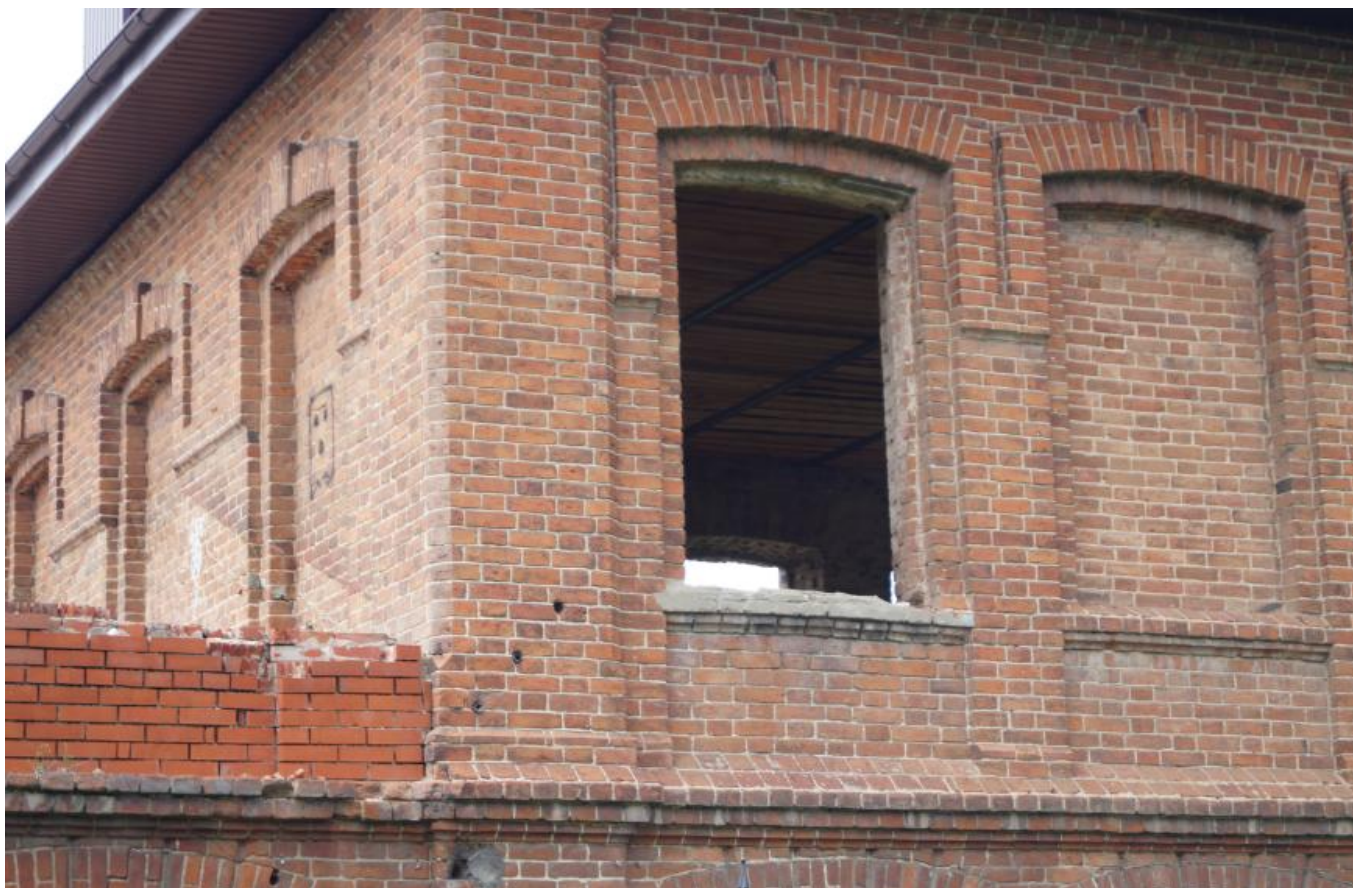
Фото 3. Вид на выявленный объект культурного наследия «Ремесленная школа», расположенный по адресу: Челябинская область, Миасский городской округ, г. Миасс, ул. Ремесленная, 8а.
