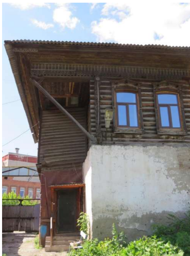
Рис. 17 а, б.. Лестничный пристрой со стороны бокового, восточного фасада. Вход на первый этаж со стороны дворового фасада
