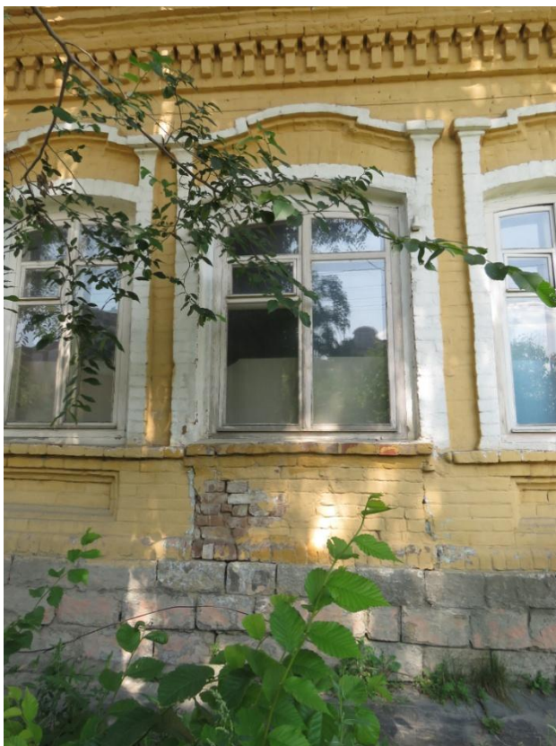
Рис. 13. Здание «Пивного зала». Фрагмент главного фасада. Заложенный дверной проем
