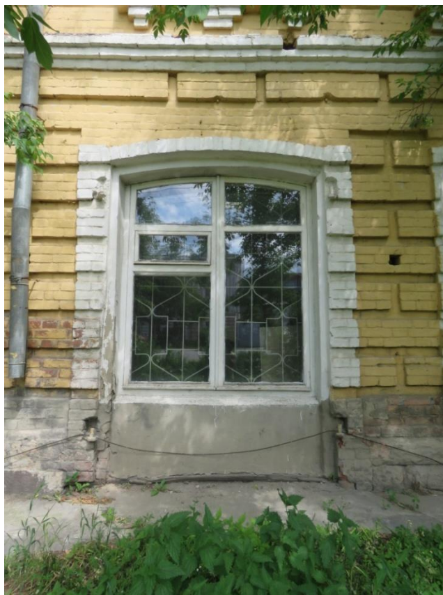
Рис. 5. Фрагмент главного фасада здания магазина. Исторический дверной проем, частично заложенный и превращенный в оконный.
