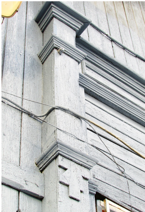
Рис. 24 Вид на боковую ленту наличника двухстворчатого окна северного ризалита здания
