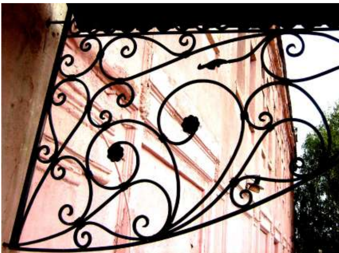
18. Троицк. Ул. Бр. Малышевых, 31. Кронштейн входного навеса. Фото 2017г.
