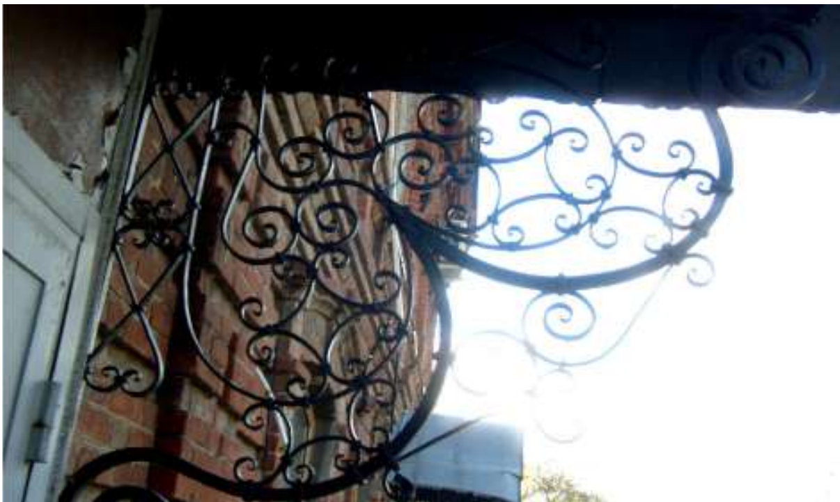
4.Троицк, ул. Фрунзе, 6. Главный фасад. Кронштейн навеса входа в здание. 2017г.
