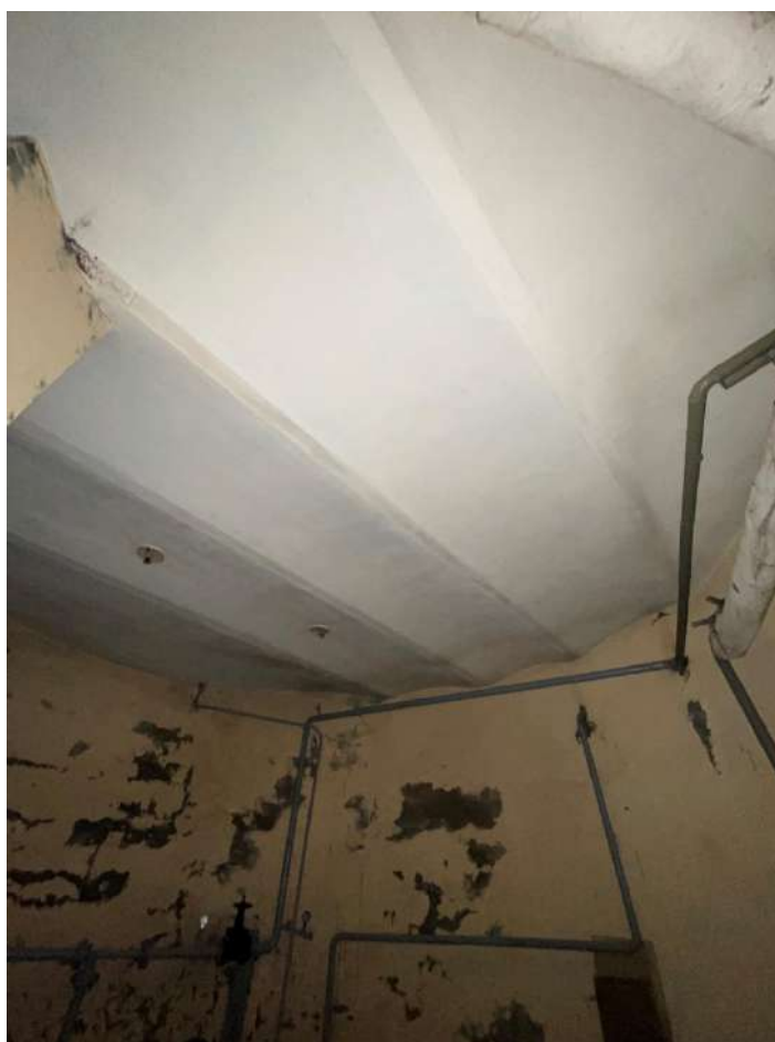
Рис. 17 а, б. Подвальное помещение под круглым в плане северо-восточным объемом бывшей операционной с перекрытием в виде бетонных сводиков по металлическим балкам
