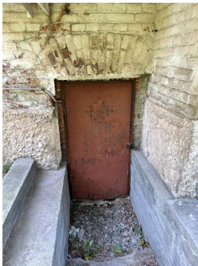
Рис. 7 а, б. Вход в подвальное помещение под круглым в плане объемом бывшей операционной с историческим дверным проемом
