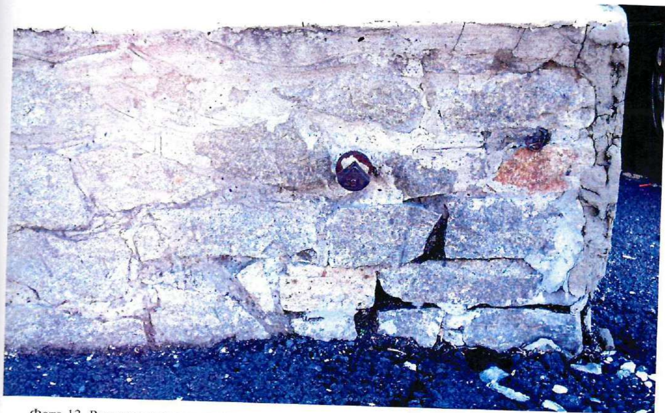
Фото 13. Разрушение цоколя здания.
