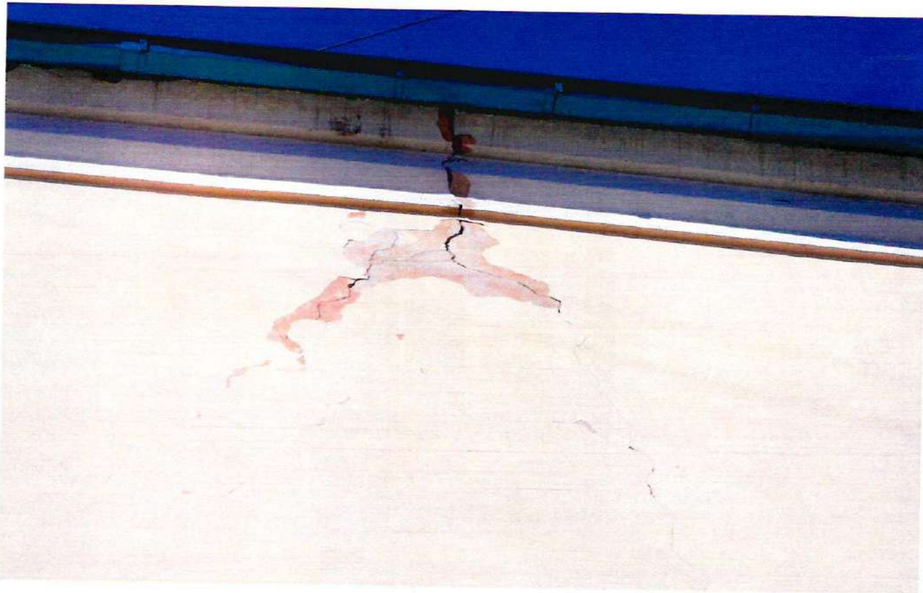
Фото 20. Дворовой фасад. Трещина в кладке прикарнизной зоны.
