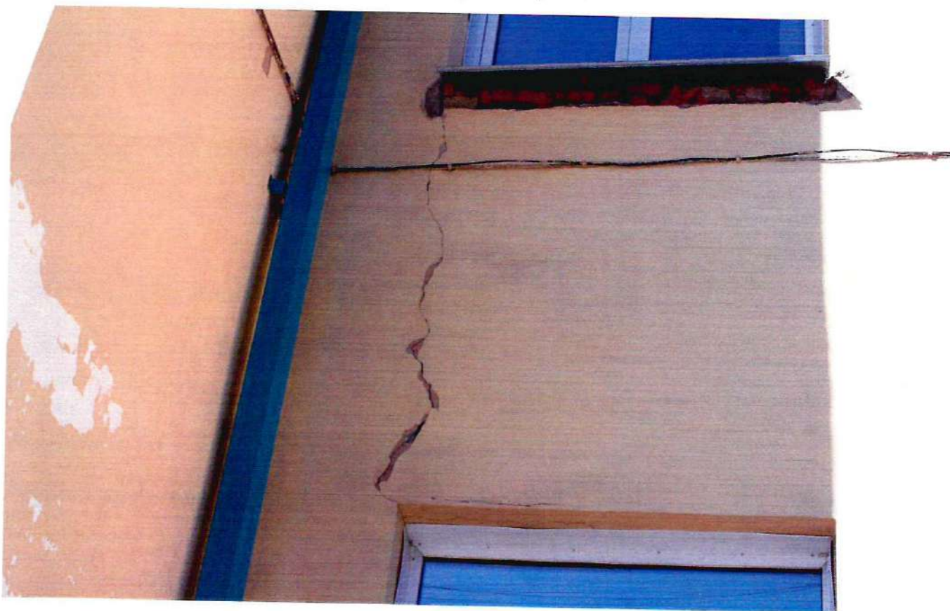
Фото 18. Дворовой фасад. Вертикальная просадочная трещина.
