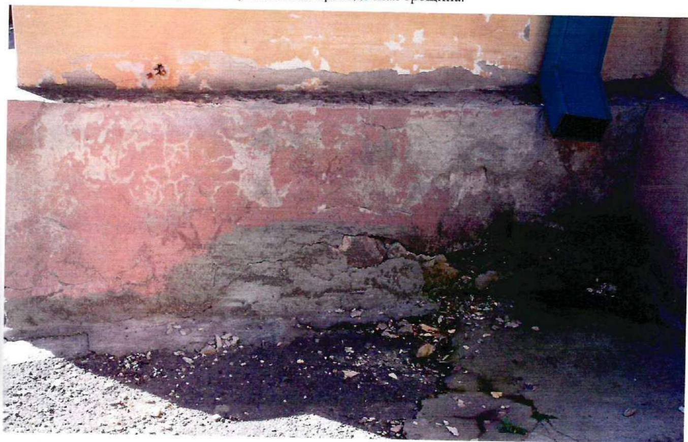
Фото 19. Дворовой фасад. Состояние цоколя и отмостки.
