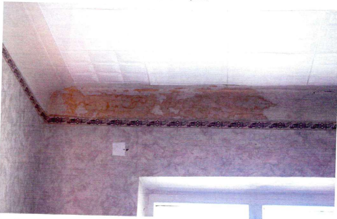
Фото 27. Интерьер. Третий этаж. Состояние потолка после протечек кровли.
