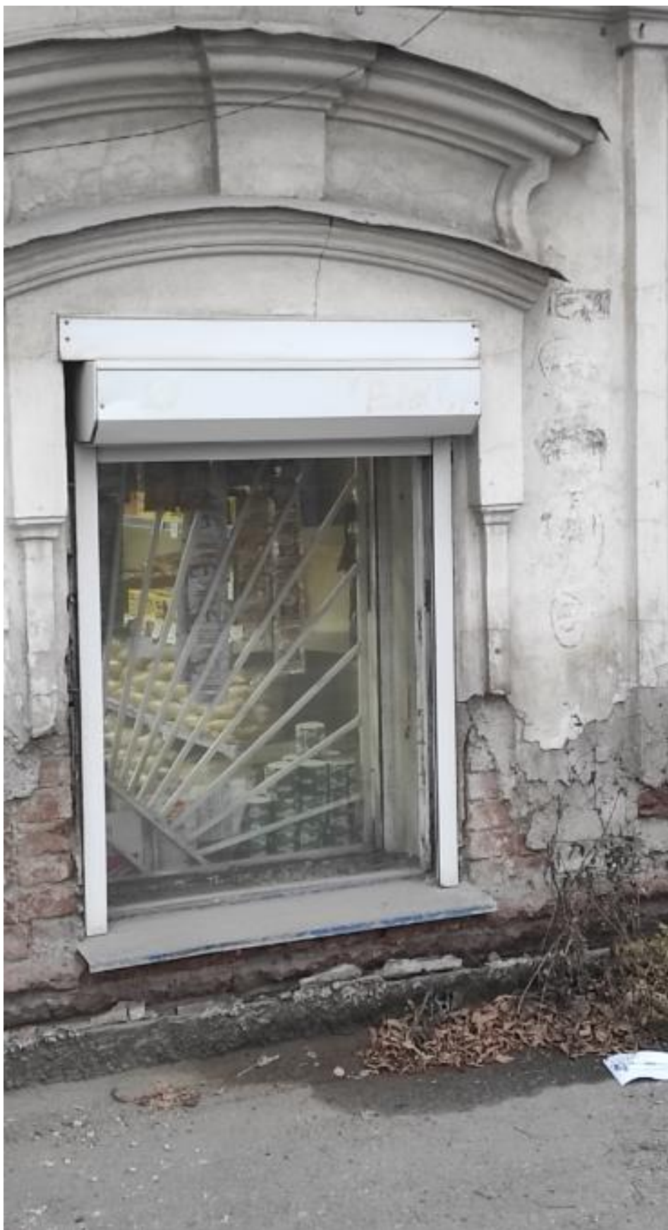
Фото 17. Вид на выявленный объект культурного наследия «Дом жилой 2-этажный каменный», расположенный по адресу: Челябинская область, Миасский городской округ, г. Миасс, Советская ул., 92.
