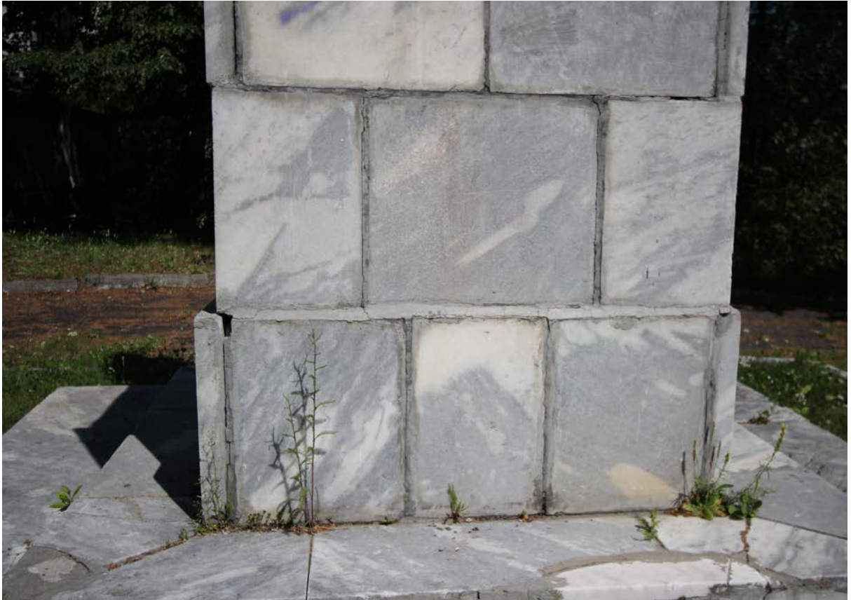
Состояние цоколя постамента. Произрастание сорных трав в швах облицовки
