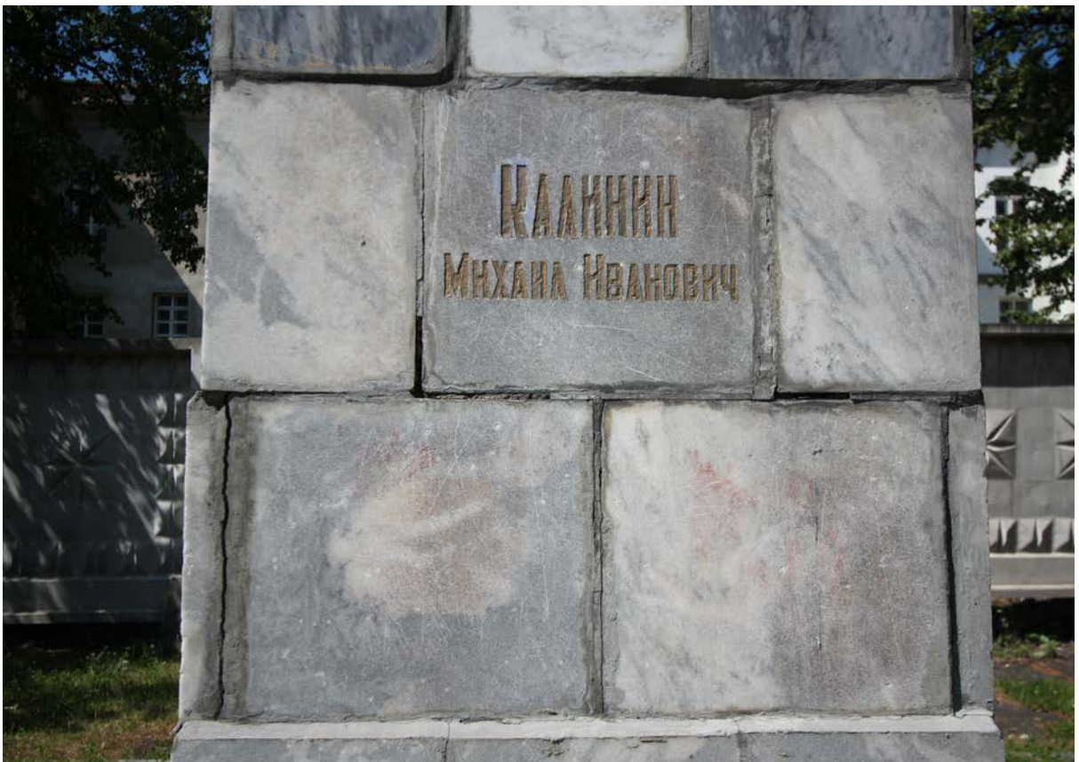
Постамент. Плиты облицовки находятся в разном уровне. Раствор выкрошен из швов. Поверхность плит сильно повреждена механически
