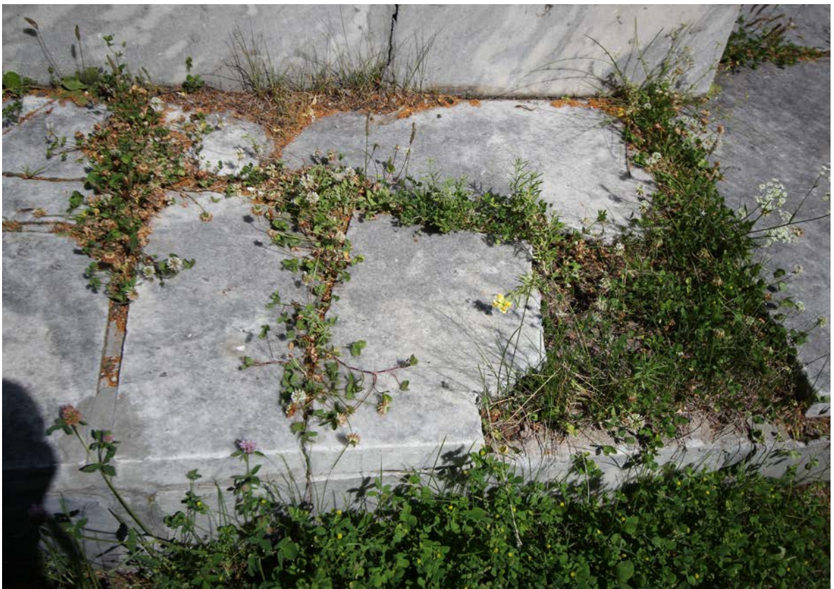
Отсутствие части плит облицовки стереобата
