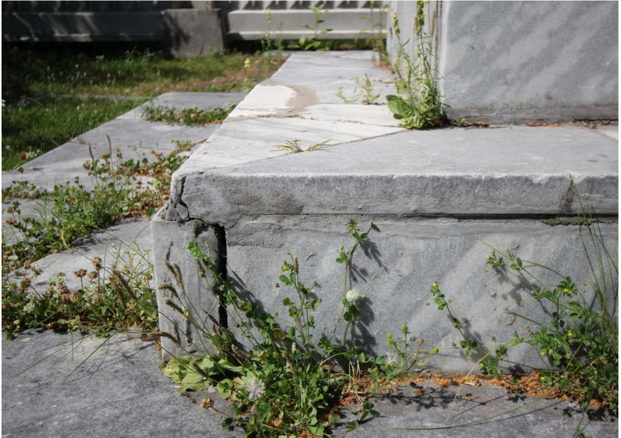
Расхождение швов облицовки
