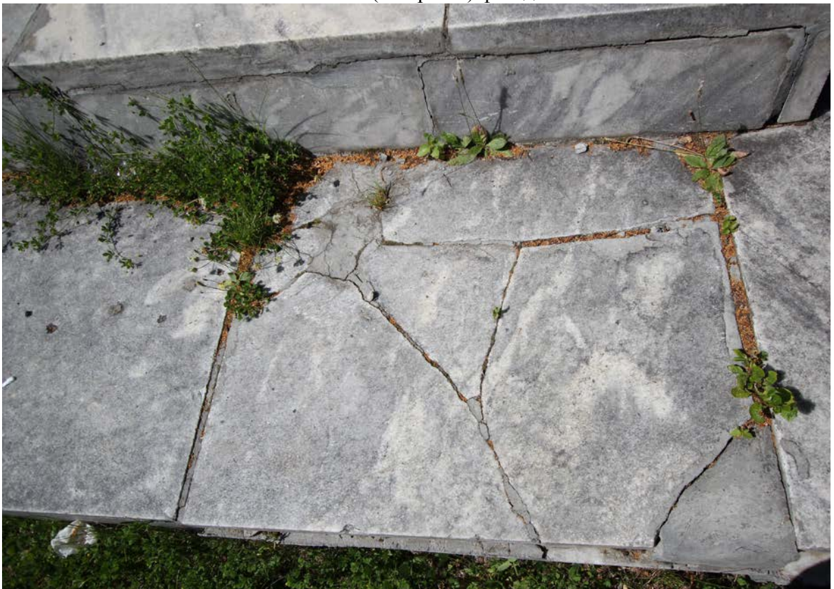
Состояние плит стереобата
