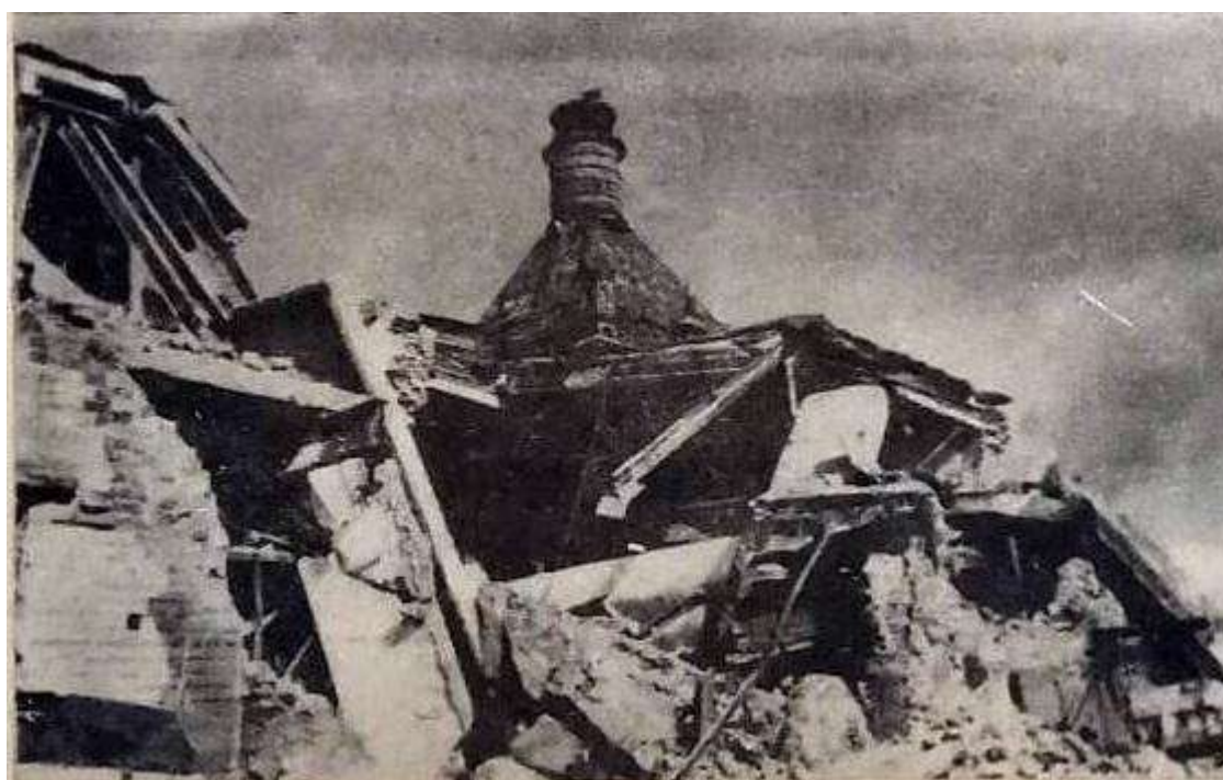
Рис.40. Здание солодовенного цеха Троицкого пивного завода после обвала стены (Фото – 1991 г., автор – И.Шамсутдинов)./ Газета «Вперёд» от 23.03.1991 г №57 (14473).
