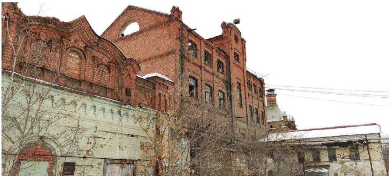
10. Вид на строения бывшего пивоваренного завода Я.Э. Зуккера (цех розлива, варочный цех, лаборатория, сушилка солодовенного цеха) со стороны юго-запада. (Фото – начала XXI в.). Ссылка: https://avatars.mds.yandex.net/get-zen_doc/5255669/pub_6182a8ec4598a221ee420be1_6182acb87d6b0c164100fc75/scale_2400 .
