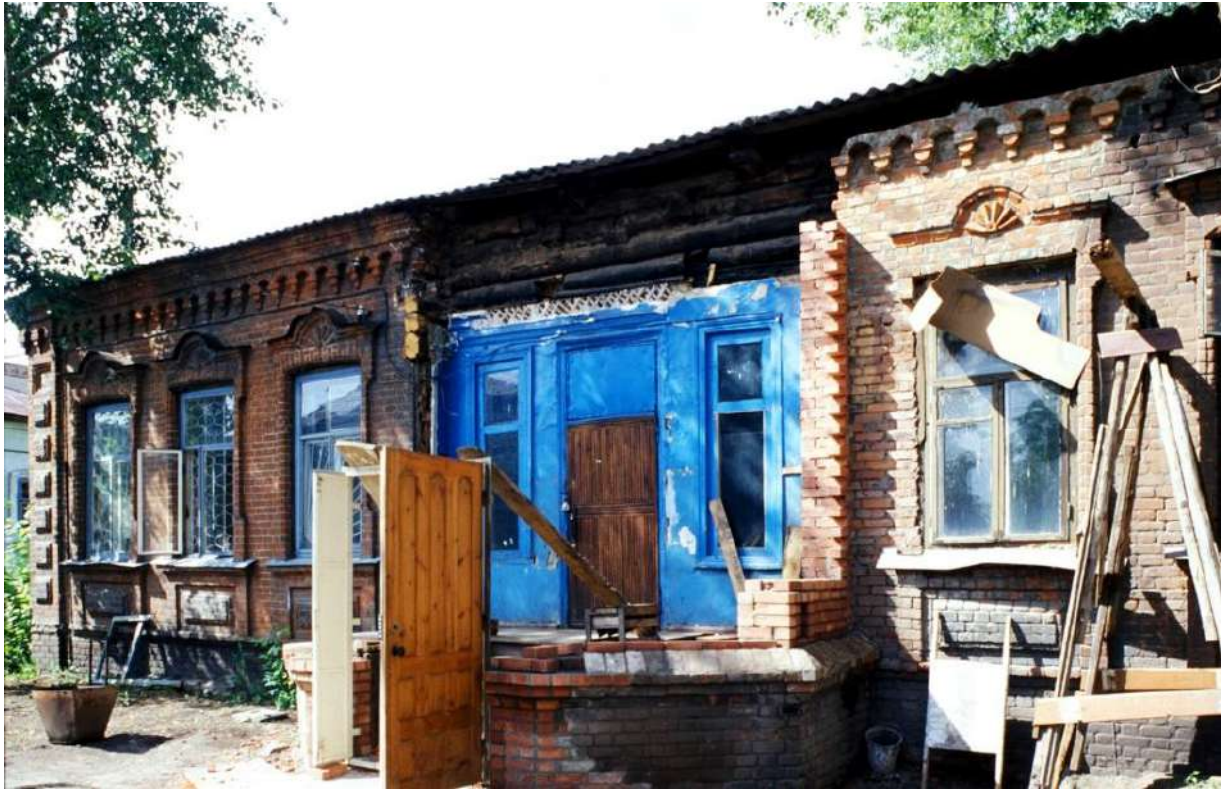
Рис.46. Вид на здание конторы в составе комплекса пивоваренного завода Я.Э.Зуккера, г.Троицк (Фото – 19 июля 2003 г., автор – У.Брумфилд). Ссылка: http://cultinfo.ru/brumfield/photoarchive/chelyabinsk_troitsk/brumfieldchel-22-22_b.jpg .
