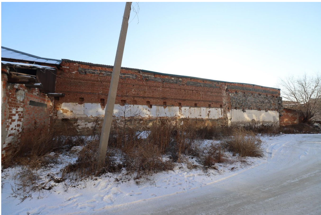
Фото 8. Вид на выявленный объект культурного наследия «Общественное здание», расположенный по адресу: Челябинская область, Троицкий городской округ, г. Троицк, ул. Красногвардейская, 81.
