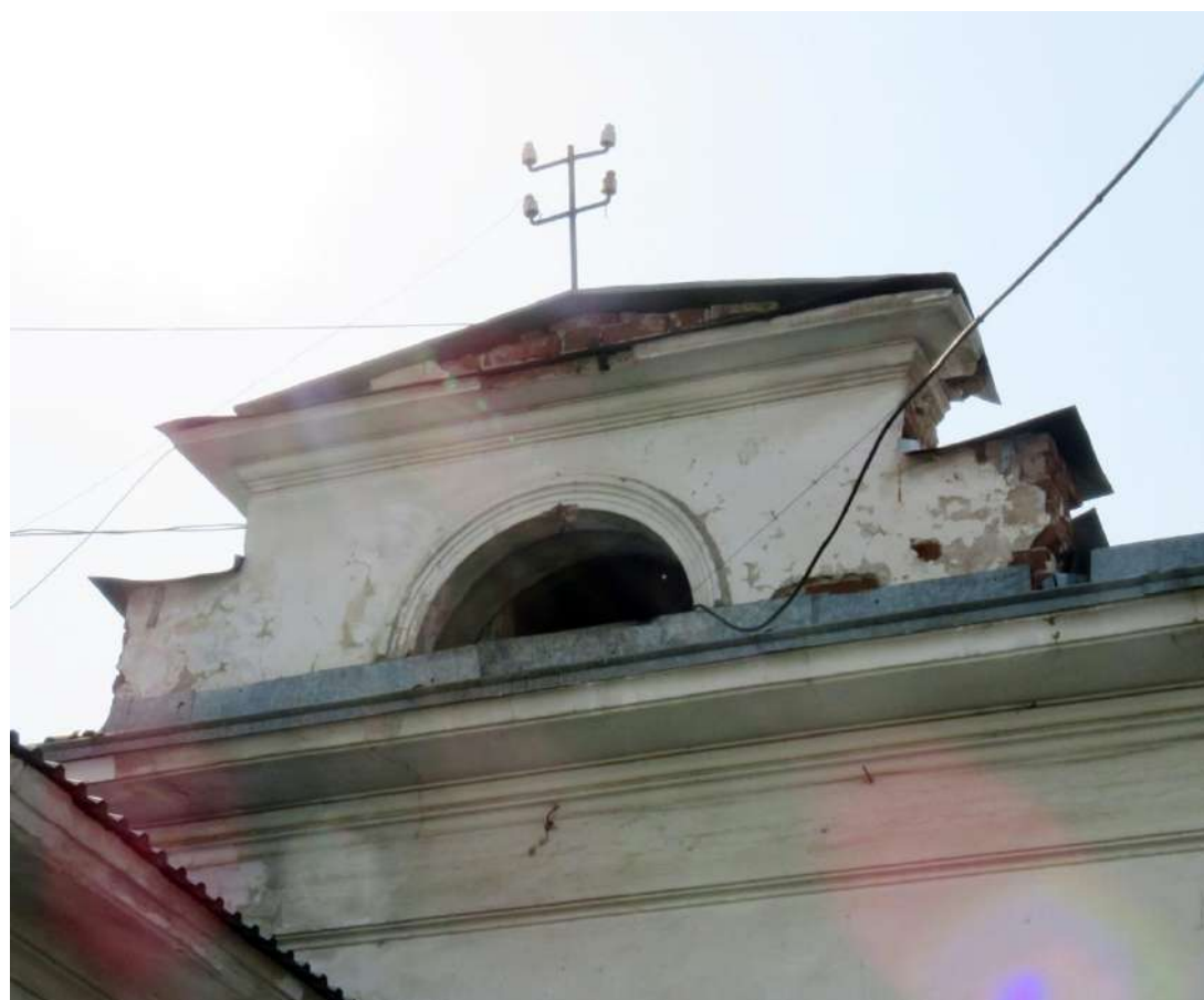
Рис. 14 а, б. Выявленный объект культурного наследия «Дом жилой, одноэтажный, каменный» (ул. Ленина, 50). Боковой, восточный фасад (вверху) и аттиковая стенка с проемом слухового окна (вверху)
