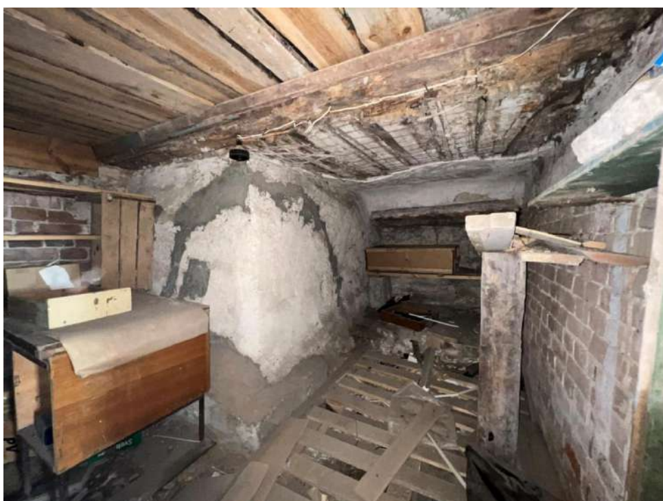
Рис. 28 а, б. Выявленный объект культурного наследия «Дом жилой, одноэтажный, каменный» (ул. Ленина, 50). Входной проем в подвал со стороны дворового фасада (вверху), подвал (внизу)
