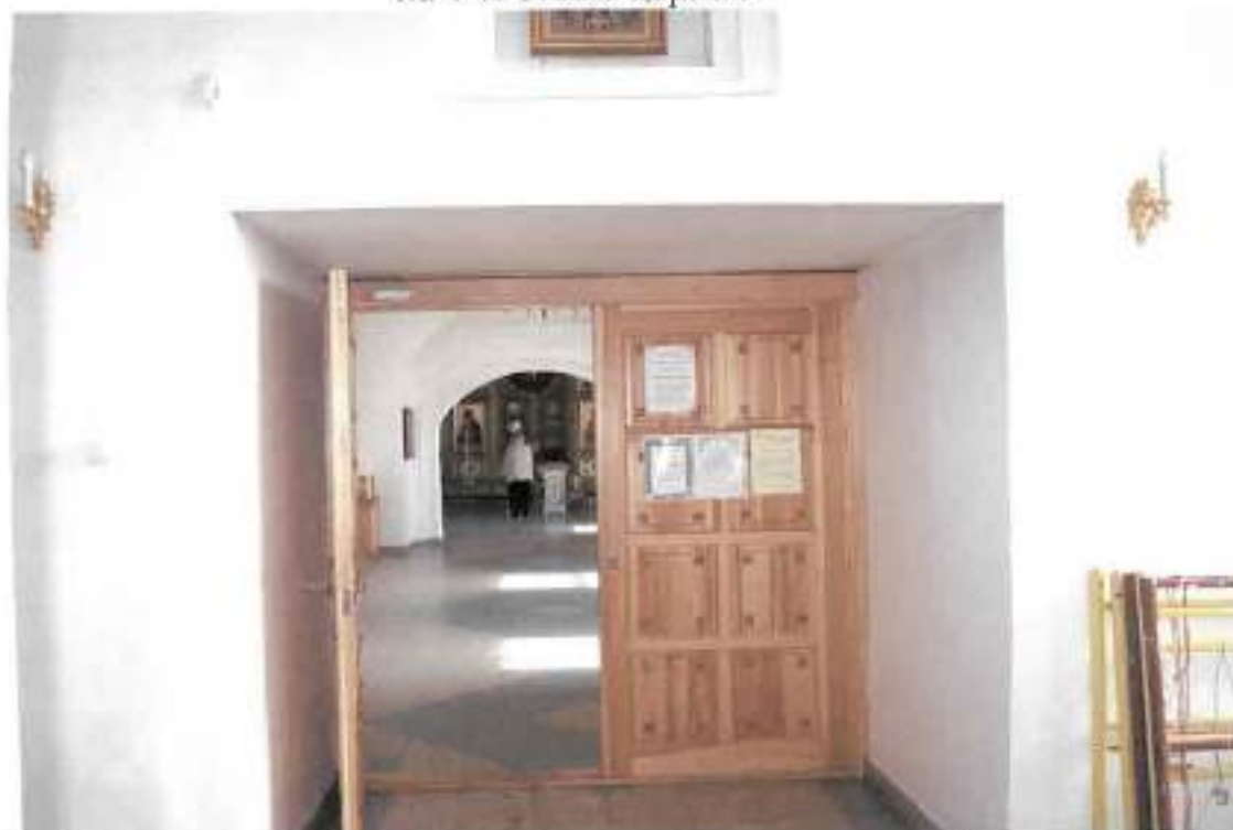
Фото 12. Вид на дверной проем из коридора в трапезную на 1-м этаже церкви
