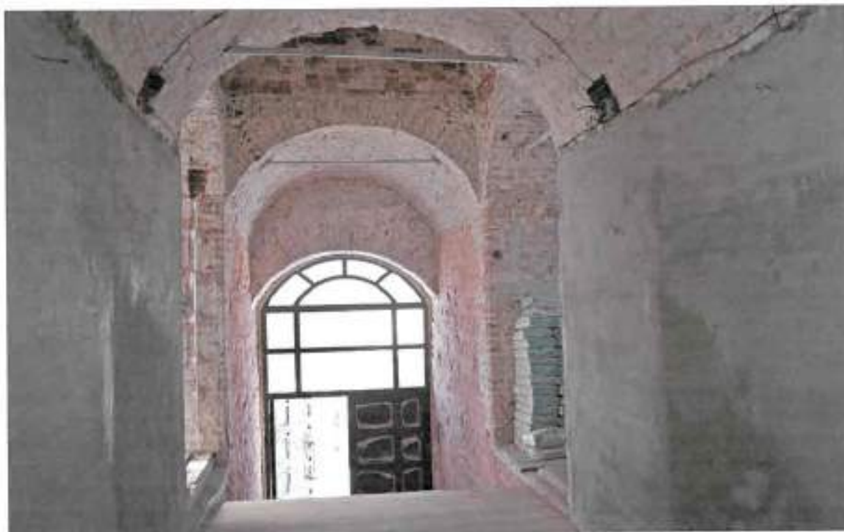
Фото 23. Вид на входную дверь из помещения № 2 (по техпаспорту БТИ), расположенного в верхнем этаже церкви
