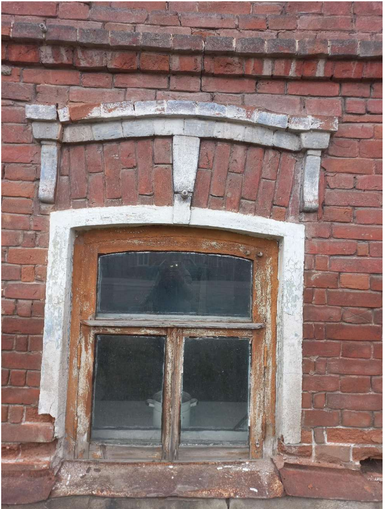
15. Оконный проем. Заполнение (переплет «Т»-образный деревянный). Металлический отлив кордона цоколя. Сандрик на фигурных кронштейнах. Замковый камень. Октябрь 2023 г.
