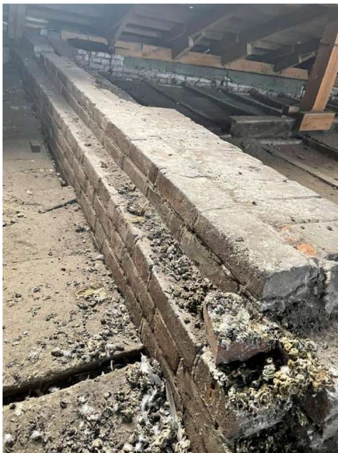
Рис. 13 а, б. Чердак объема исторического здания. Фрагменты исторической кирпичной кладки поперечных стен
