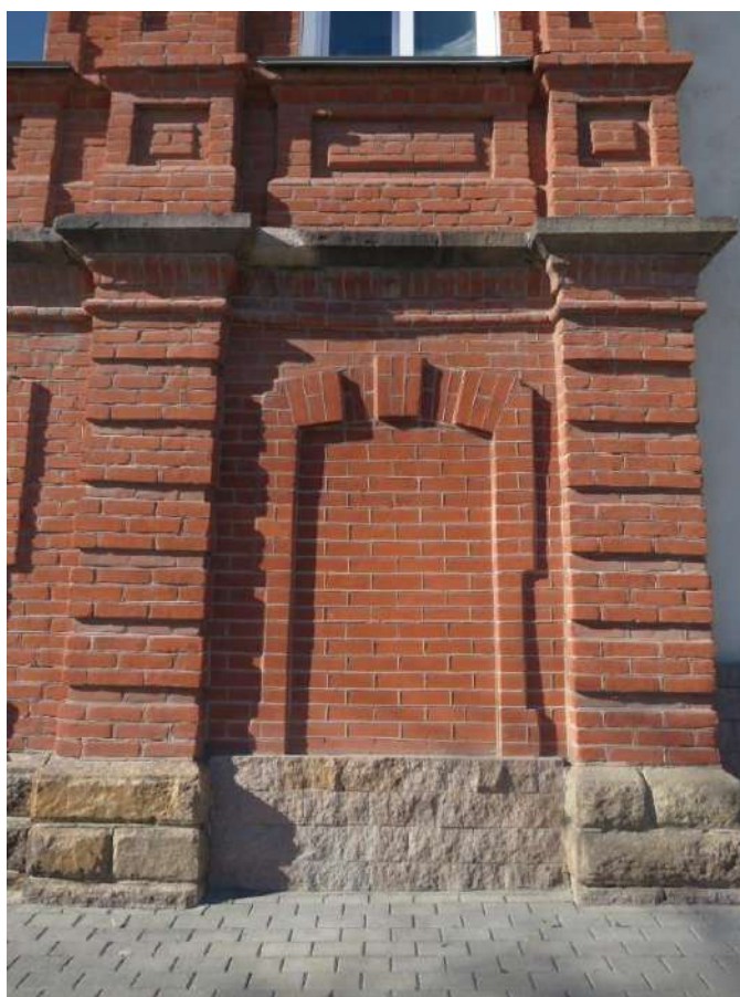
Рис. 6 а,б. Фрагменты бывших лестничных объемов на левом фланге западного (а) и правом фланге южного (б) фасадов. Бывшие входные проемы.
