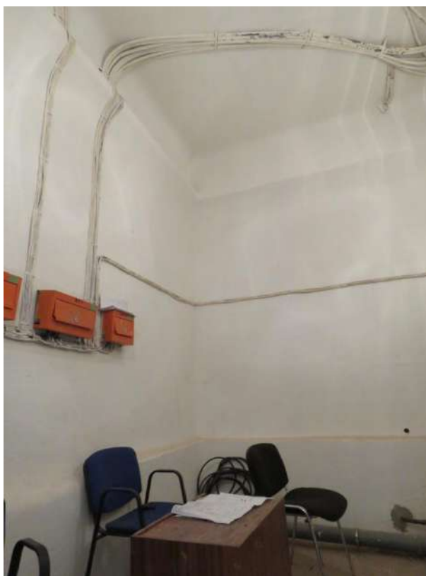
Рис. 15. Фрагмент бывшей внешней стены исторического здания (стык торца лестничного объема на левом фланге западного фасада и стены северного фасада основного объема)
