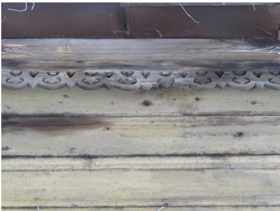
Рис. 10. Подзор с пропиленной резьбой западного фасада
