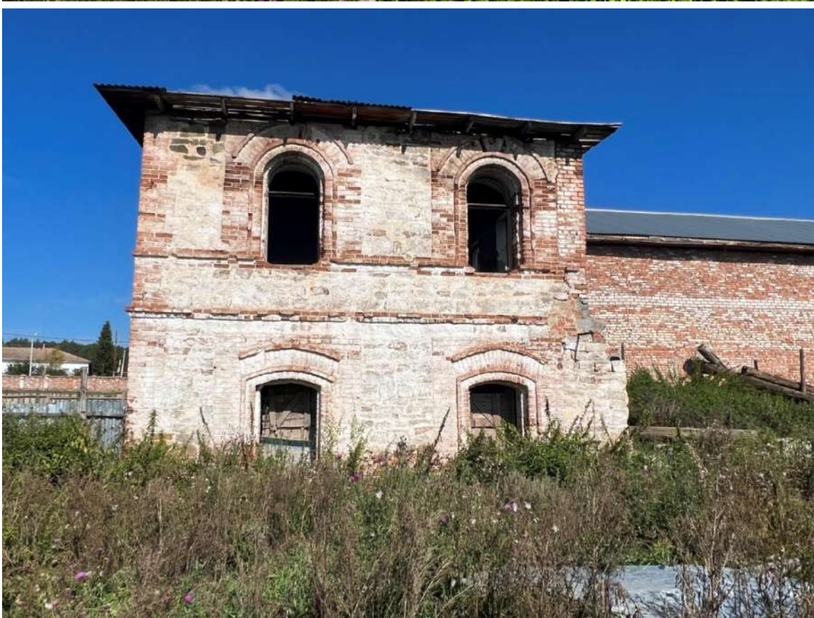
Рис. 33 а, б. Двухэтажный (в настоящее время – двухсветный) производственный корпус. Выступающий объем со стороны южного фасада
