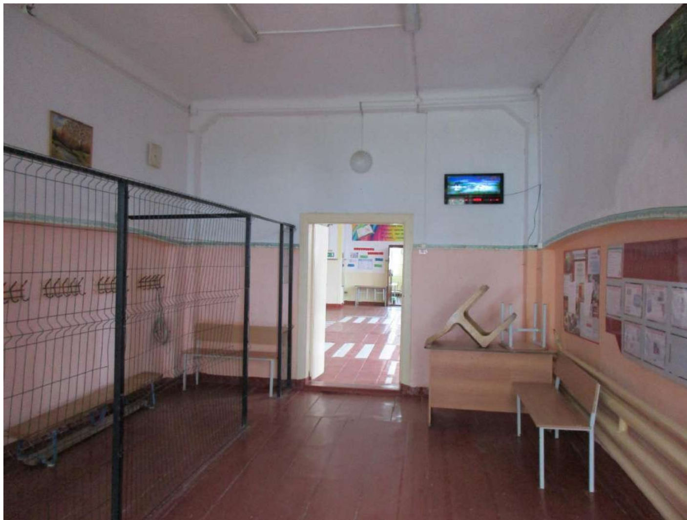
21. Интерьер. Арочный проем между «раздевальней» и «рекреационным залом» согласно проекту, утв. в 1913 г., заложен. См. также илл. 23. Август, 2023 г.
