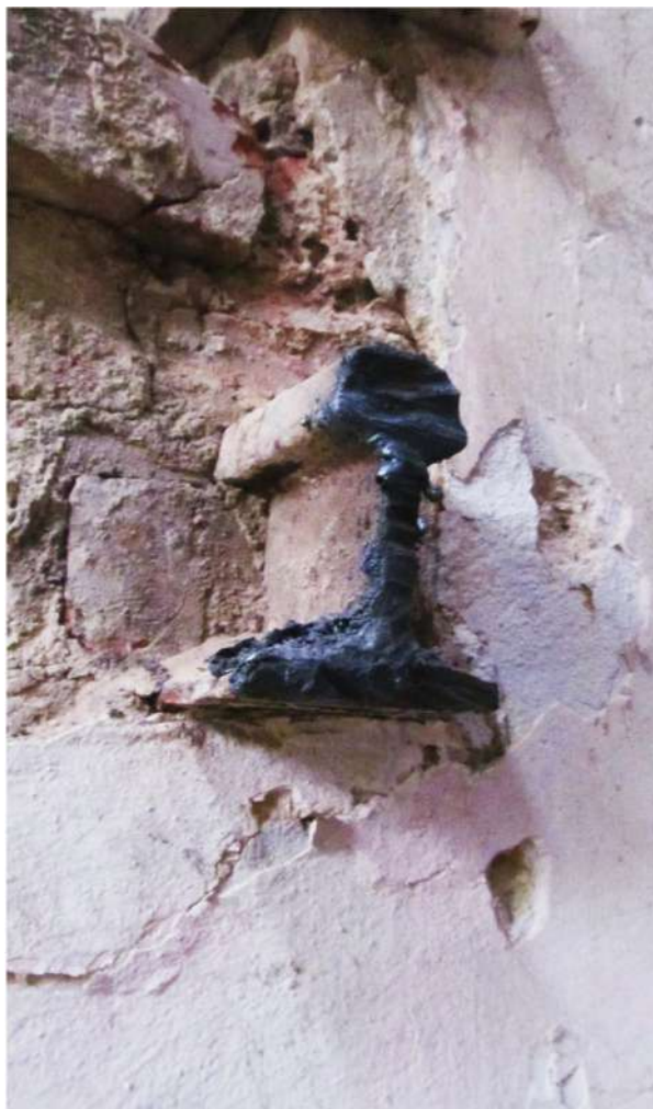
Рис.30 Вид на обрезок подкосоурной балки лестницы на 2-ой этаж бывшей казармы (Лит. 18)
