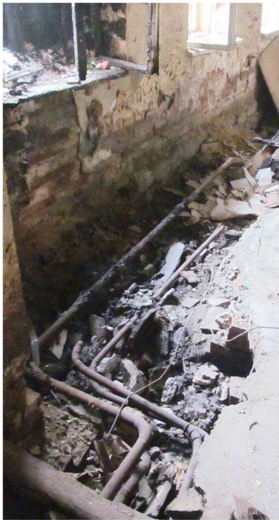
Рис. 24 Вид на разрушенный пол и инженерные сети помещения бывшей казармы (Лит. 18)
