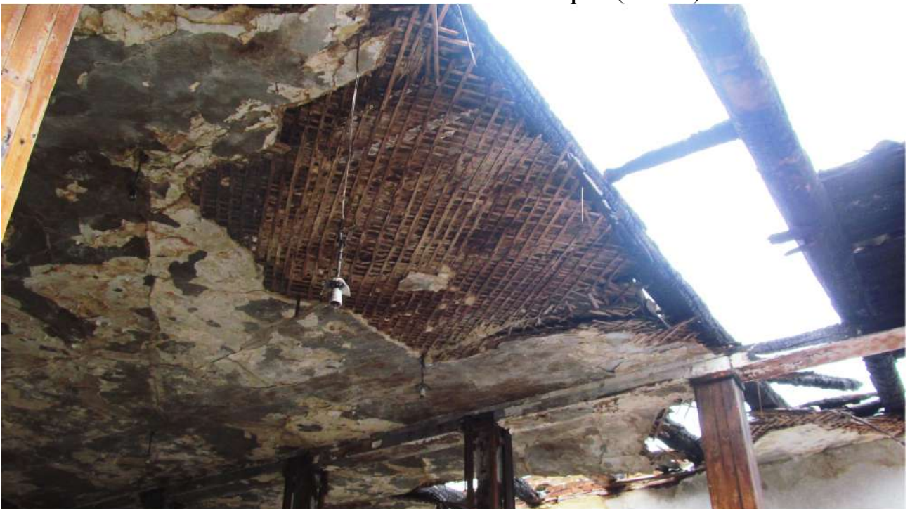
Рис. 66 Вид на разрушенную кровлю помещения 2-го этажа бывшей казармы (Лит. 17)
