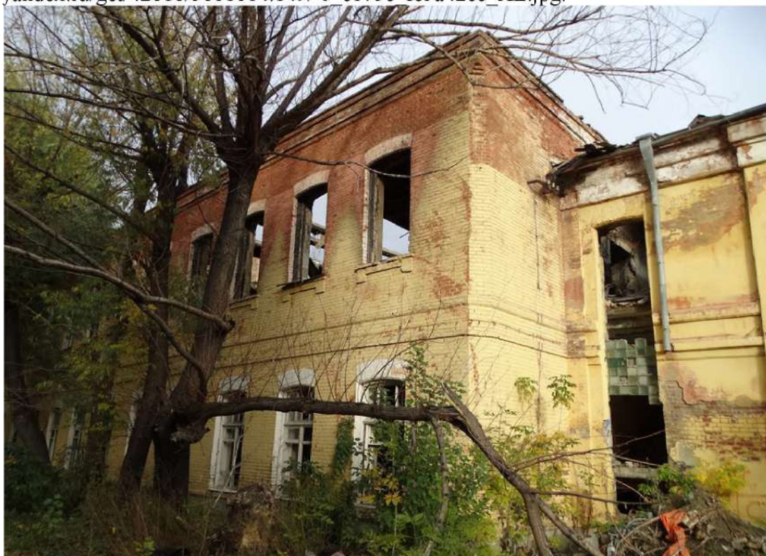
Рис. 59 Здание Казармы № 2 бывшего Войскового остановочного пункта по ул. Монакова, 1а/3 (Фото - октябрь 2016 г., автор – Ю.В. Латышев). Ссылка: https://img-fotki.yandex.ru/get/194989/5661614.149/0_c175d_52d2f319_XL.jpg .
