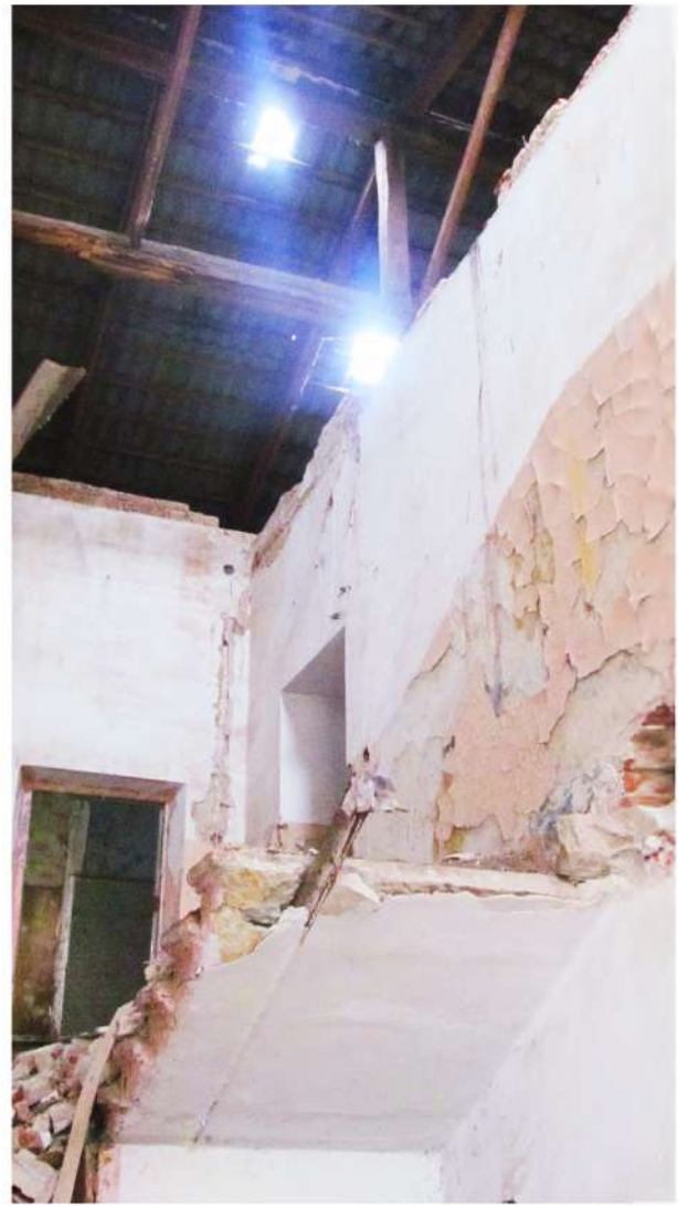
Рис. 28 Вид на разрушенную лестничную клетку бывшей казармы (Лит. 18)
