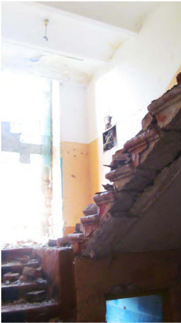
Рис. 52 Вид на разрушенную лестничную клетку бывшей казармы (Лит. 17)
