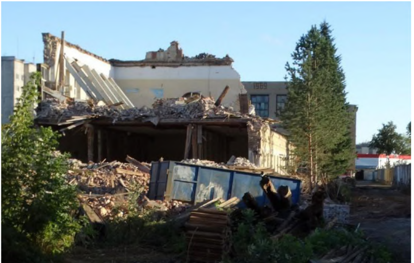
Рис. 103 Вид на здание бывшей казармы (Лит. А) с севера со стороны дворовой территории
